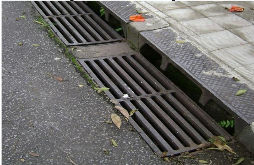
Figura 22: Boca de lobo com grelha
