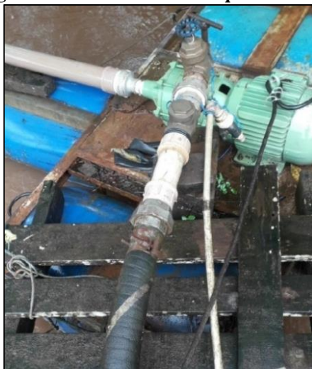
Figura 99 - Barrilete de Recalque da Bomba.
