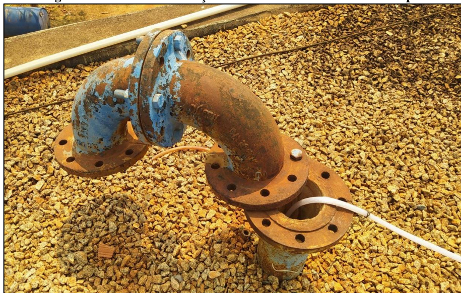
Figura 75 - Processo de Adição de Cloro – ETA da Sede Municipal.
