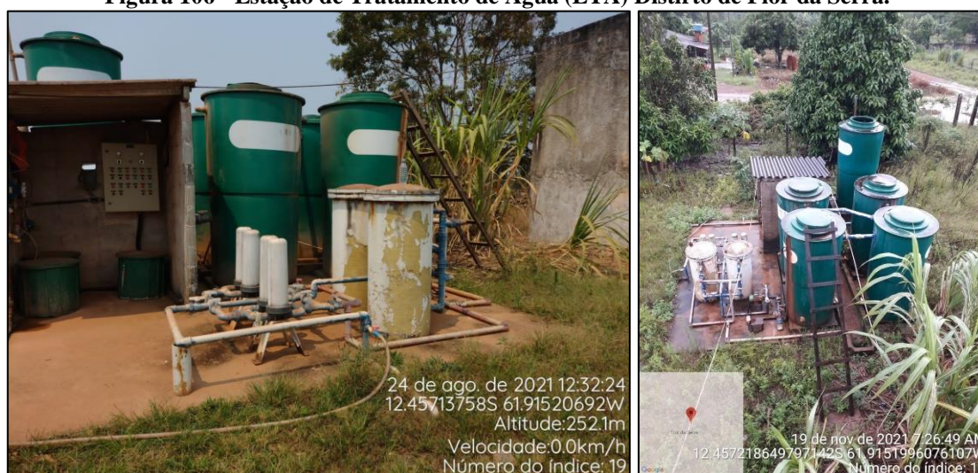
Figura 106 - Estação de Tratamento de Água (ETA) Distrito de Flor da Serra.
