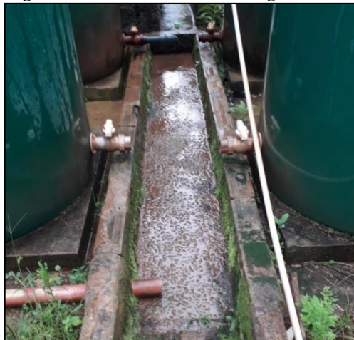
Figura 113 - Canaleta de Descarga da ETA.
