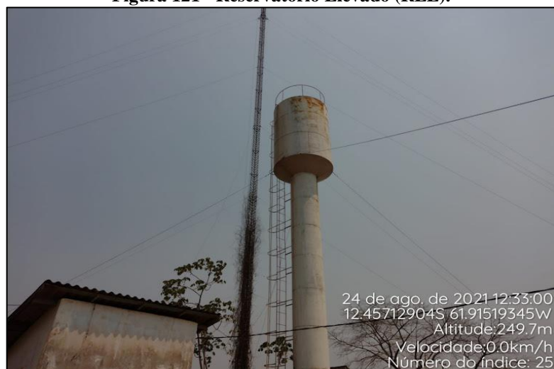
Figura 121 - Reservatório Elevado (REL).
