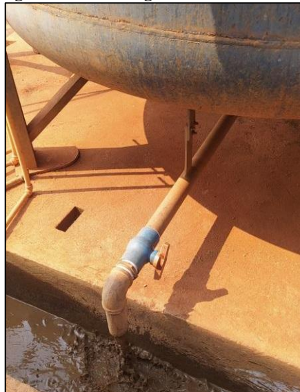
Figura 72 - Descarga do Lodo de Fundo.
