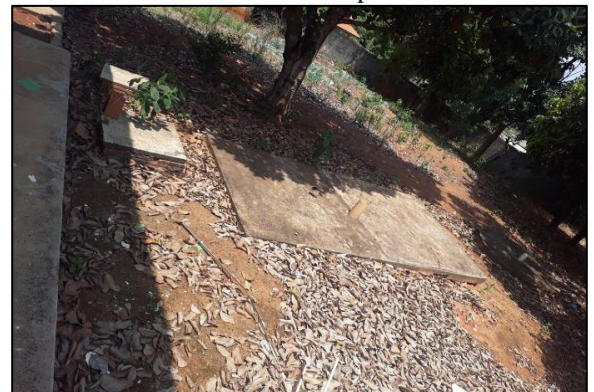
Fossa Séptica na E. M. E. I. Dalva Pereira da Silva – Sede Municipal.
