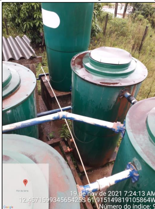
Figura 109 - Flocculador e Tanques de Decantação.
