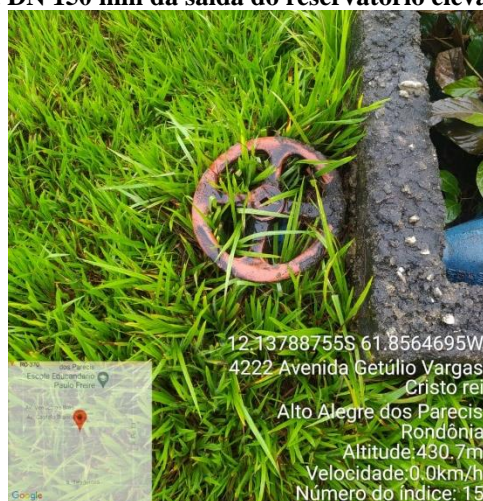
Figura 88 - Registro de gaveta DN 150 mm da saída do reservatório elevado para a rede de distribuição.
