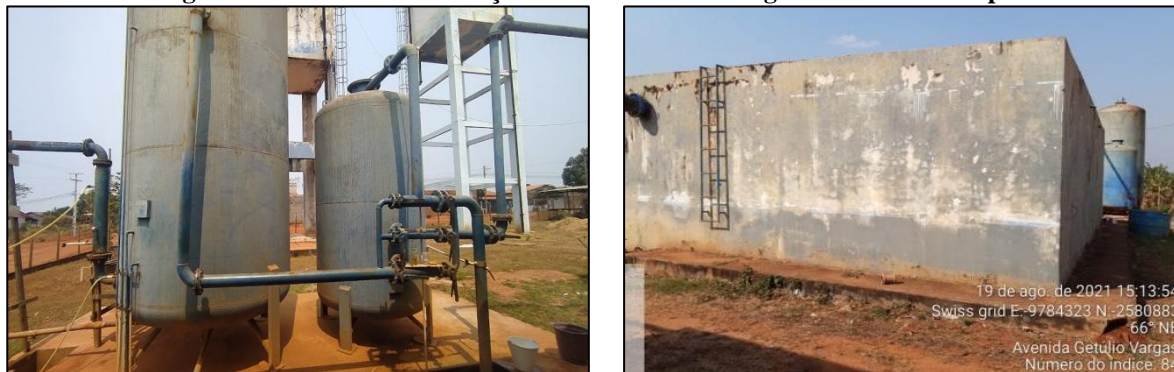
Figura 69 - Unidades da Estação de Tratamento de Água da Sede Municipal.
