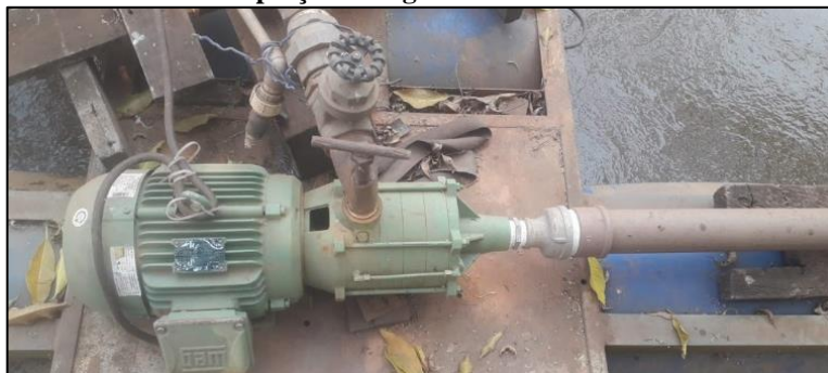
Figura 98 - Motobomba - Captação de Água Bruta Distrito de Flor da Flor da Serra.
