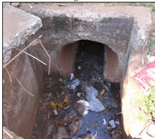
Lançamento de Esgoto. 11°11'39.94"S e 61°30'55.00"W.
