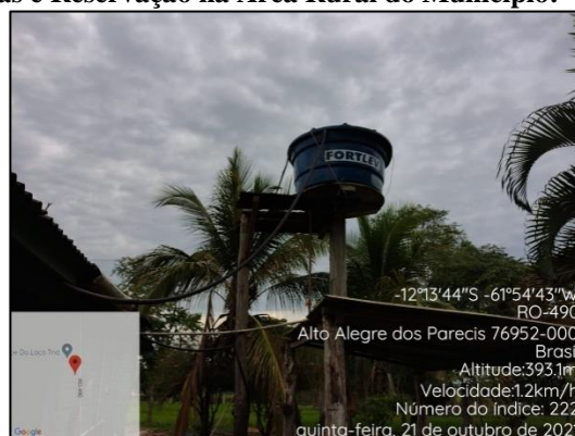
RO-490 – Caixa de Reservação (500 Litros).
