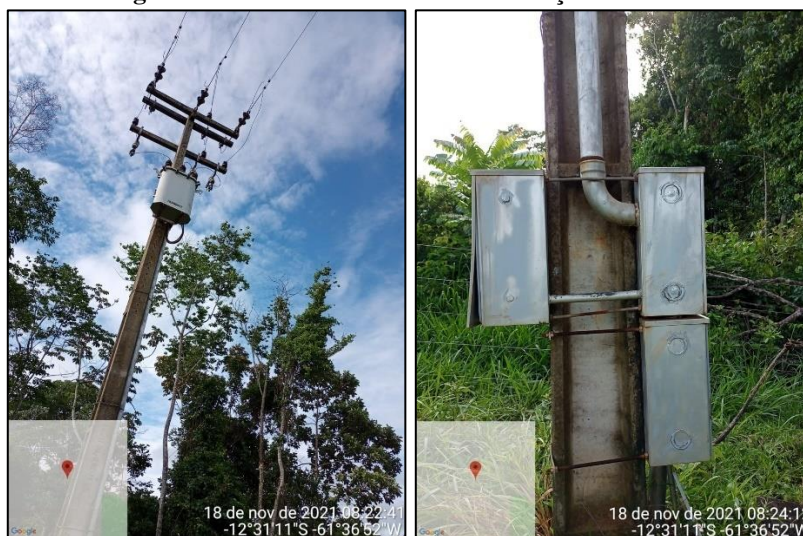
Figura 132 - Transformador e Subestação Trifásica.
