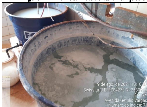
Bomba Dosadora e Tanques de Diluição de Polímero Não Iônico e Hipoclorito de Cálcio.
