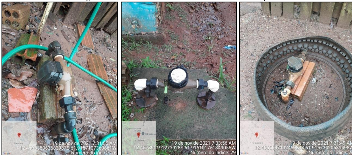
Figura 123 - Cavaletes com Hidrômetros sem Proteção.
