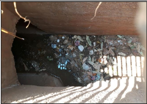
Acúmulo de Resíduos no Interior de Boca de Lobo, na Av. Tancredo de Almeida Neves. 12°07'58.24"S e 61°51'28.01"W.
