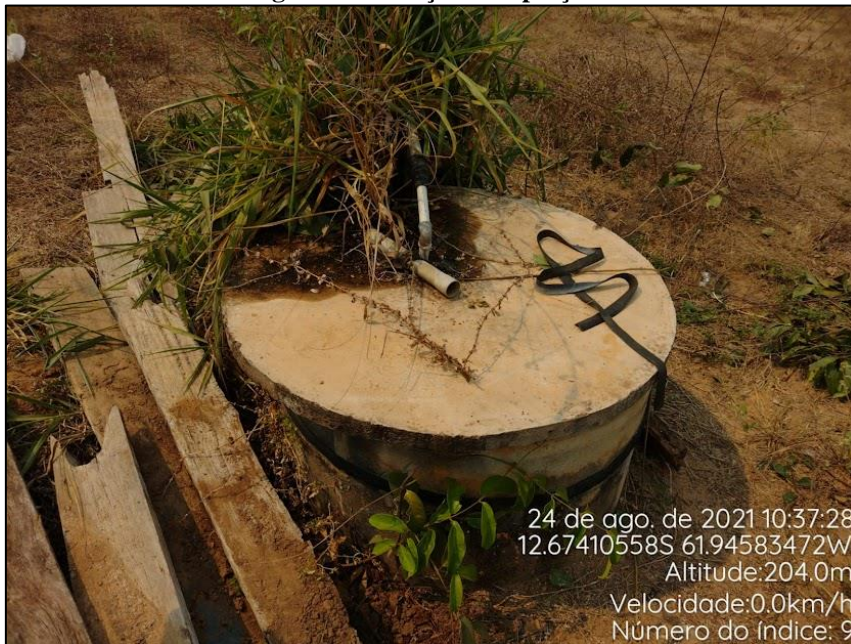
Figura 144 - Poço de Captação Comunidade São Luiz da União
