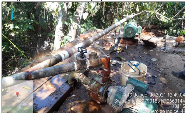
Figura 128 - Motobomba - Captação do Distrito de Vila Bosco
