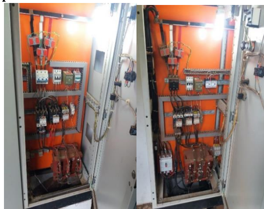
Vista Interna do Painel de Comando.
