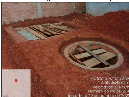
Constru o de Fossa S ptica em Quintal, Av. Tancredo Neves. 12°08'21.00''S e 61°51'28.00''W.
