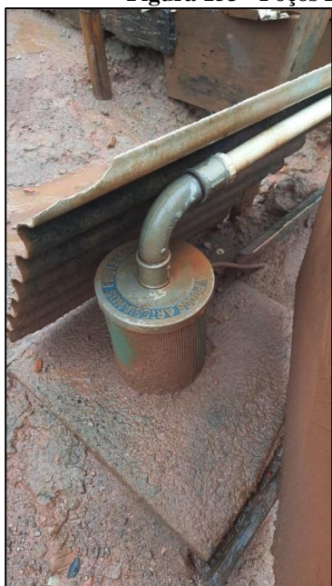
Poço Tubular Profundo, na Avenida São Francisco, 3940, Jardim das Palmeiras.
