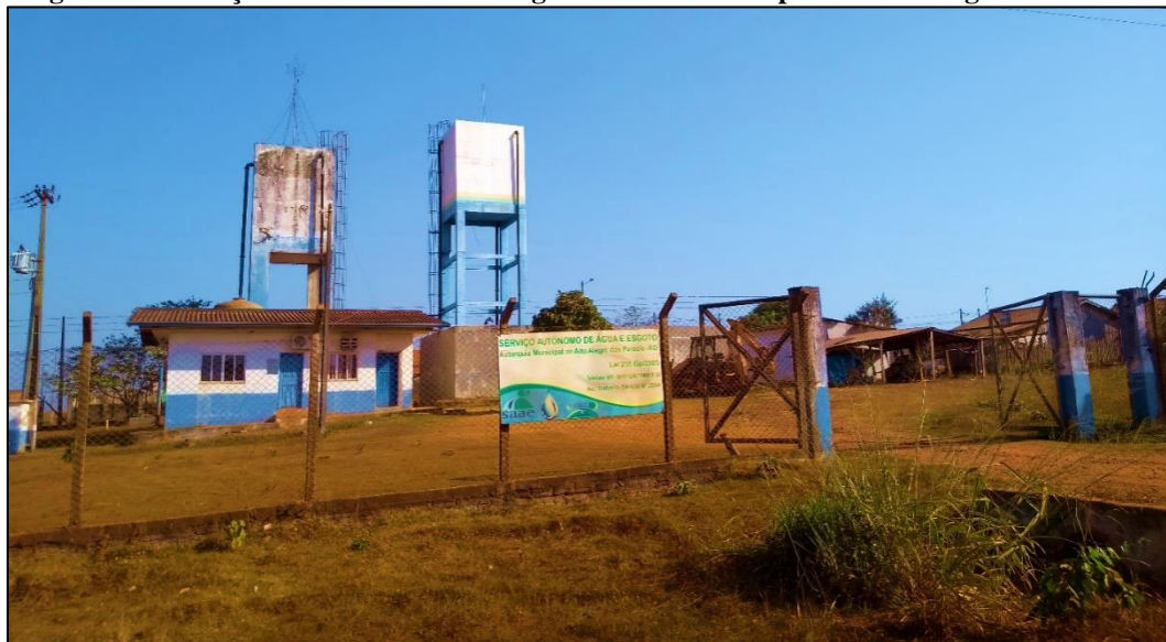
Figura 43—Estação de Tratamento de Água na Sede Municipal de Alto Alegre dos Parecis.
