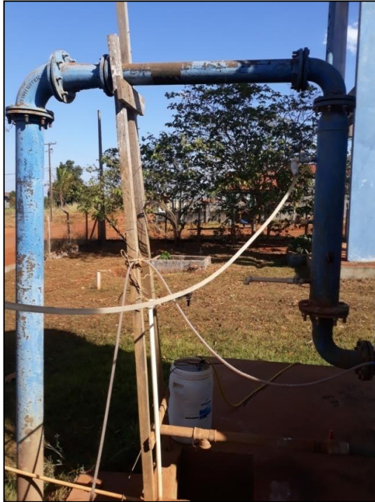
Figura 70 - Dispersor Hidráulico da ETA da Sede Municipal.
