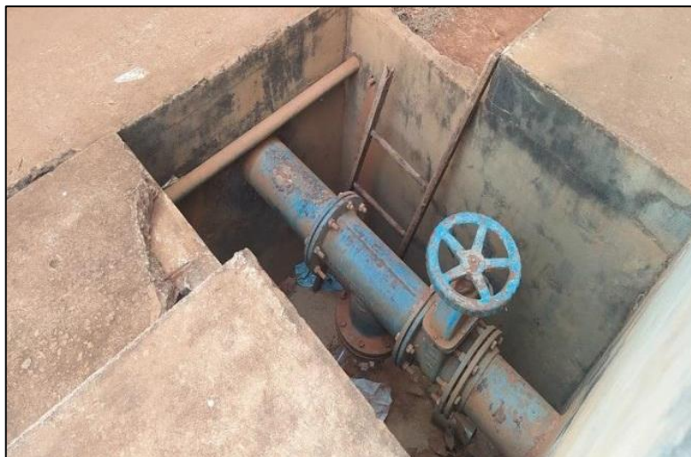
Figura 84 - Adutora de Água Tratada de ferro fundido DN 150 mm com registro de gaveta de ferro fundido DN 150 mm
