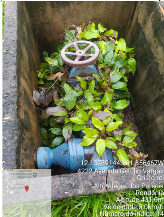
Figura 87 - Registro de gaveta DN 150 mm da saída do reservatório apoiado para o reservatório
