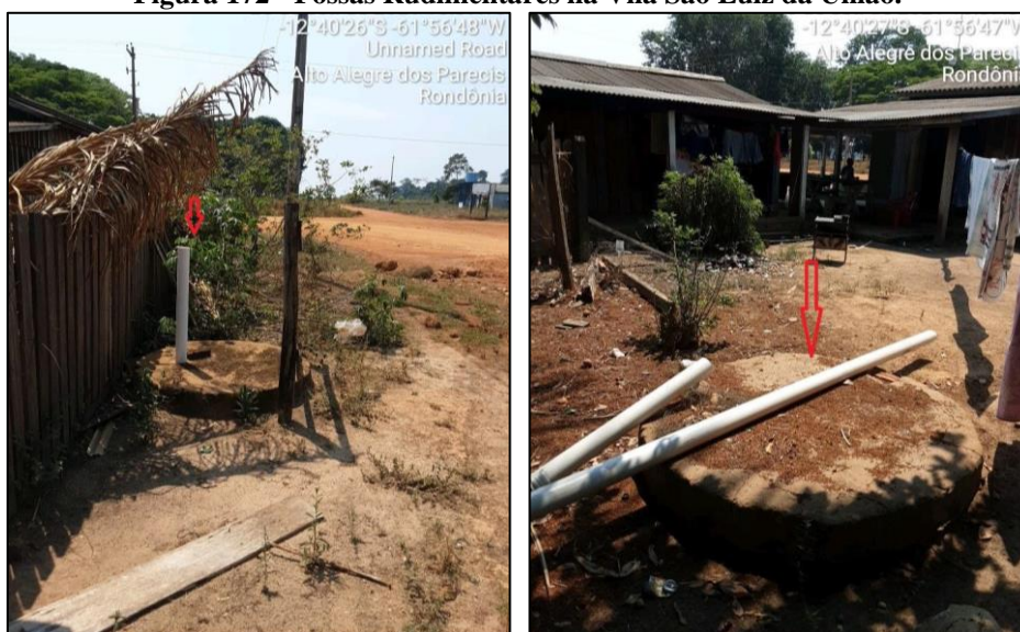
Figura 172 - Fossas Rudimentares na Vila São Luiz da União.
