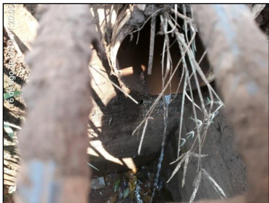
Lançamento de Esgoto na Rede de Drenagem, na Av. Tancredo de Almeida Neves. 12°07'57.25"S e 61°51'31.58"W.
