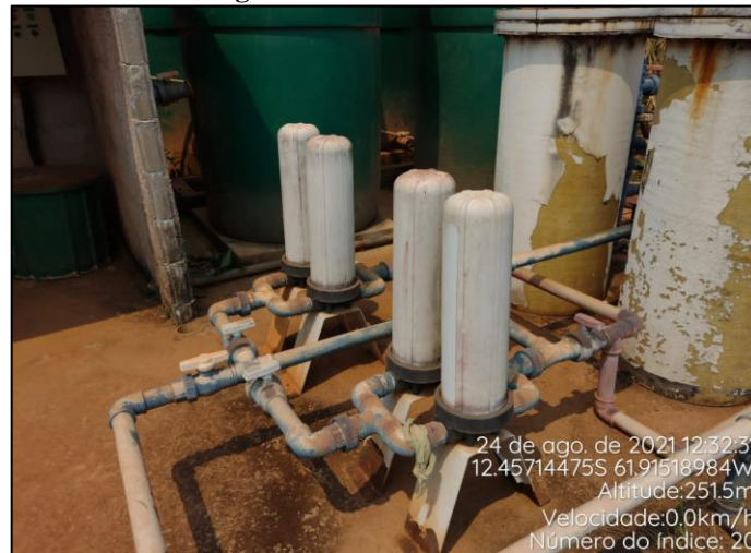
Figura 110 - Filtros da ETA.
