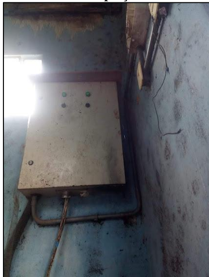
Figura 101 - Vista Interna do Painel de Captação.
