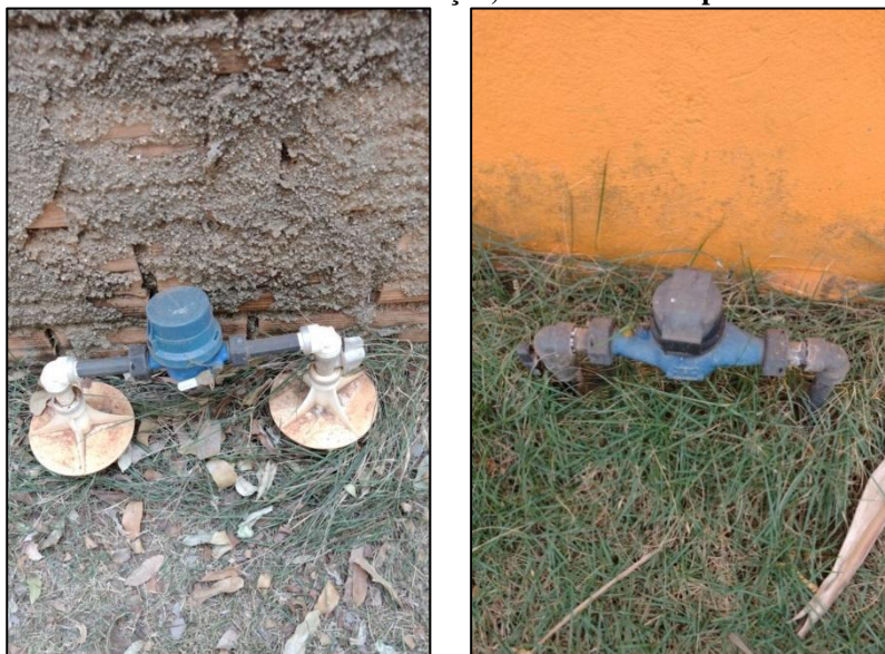
Figura 92 - Cavaletes com Hidrômetros sem Proteção, na Sede Municipal de Alto Alegre dos Parecis.
