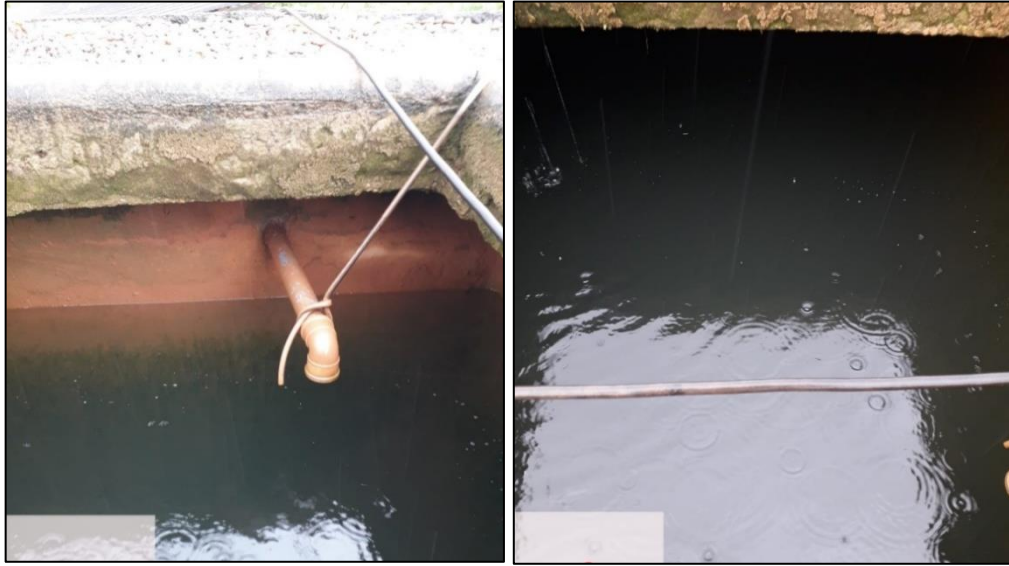
Figura 112 - Tanque de Contato.
