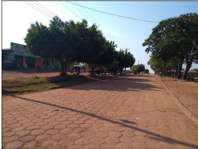
Figura 205 - Meio-Fio e Sarjeta em Boas Condições, na Rua Principal do Distrito de Flor da Serra.
