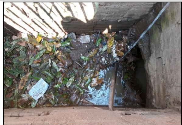
Lançamento de Águas Residuárias em Boca de Lobo, na Av. Tancredo de Almeida Neves. 12°07'57.94"S e 61°51'30.30"W.
