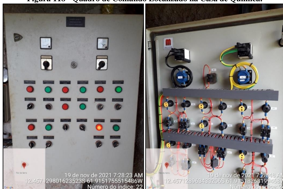
Figura 118 - Quadro de Comando Localizado na Casa de Química.
