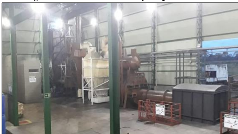
Figura 267 - Incinerador Utilizado para Queima dos RSS.
