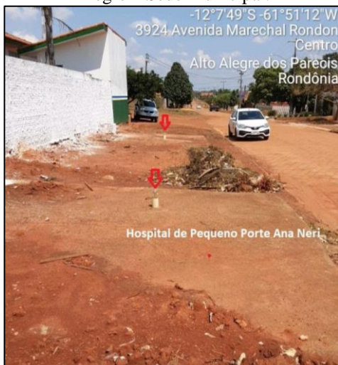
Fossa Rudimentar no Hospital de Pequeno Porte Ana Neri – Sede Municipal.
