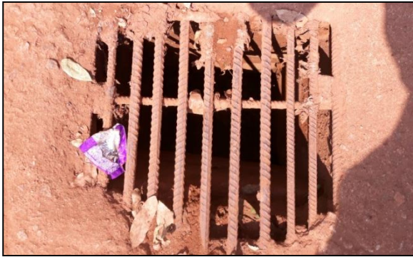
Boca de Lobo Obstruída, na Av. Tancredo de Almeida Neves. 12°07'58.13"S e 61°51'28.49"W.
