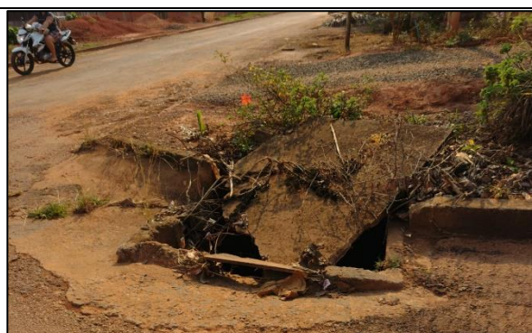
Dispositivo com Tampa Quebrada, na Av. Marechal Rondon. -12.13021765S; -61.85542838W.
