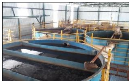
Estação de Tratamento de Efluentes – ETE.
