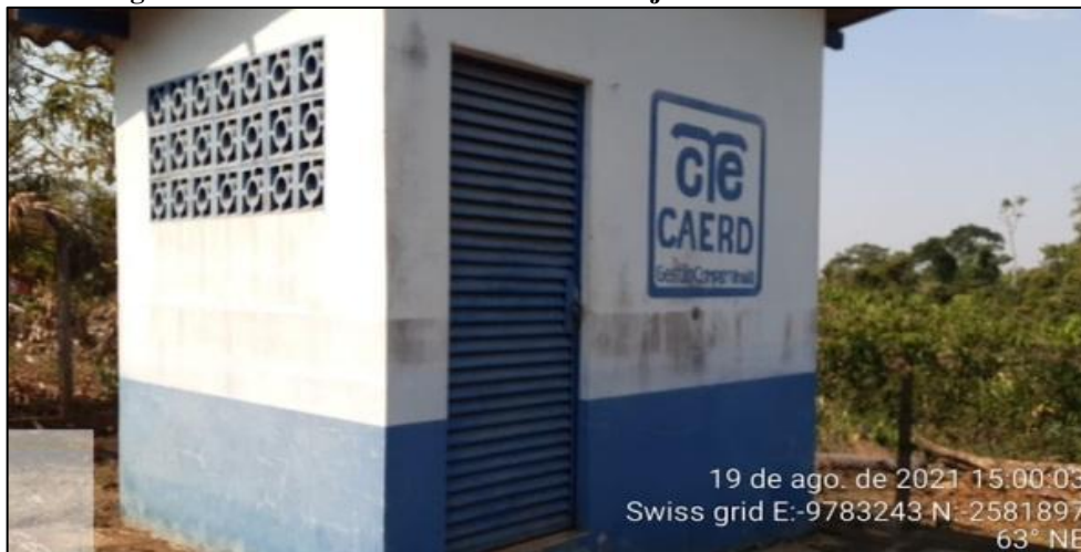
Figura 63 - Abrigo onde é realizado o acionamento do conjunto motobomba do sistema de captação
