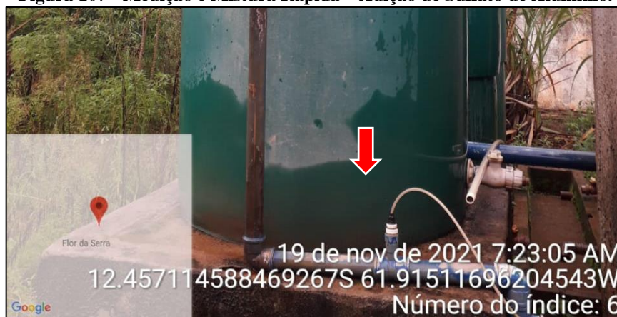
Figura 107 - Medição e Mistura Rápida – Adição de Sulfato de Alumínio.
