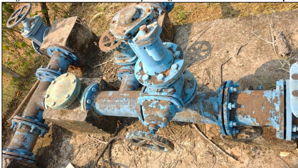
Figura 62 - Barrilete - Sistema de Elevação de Água Bruta do SAA da Sede Municipal.
