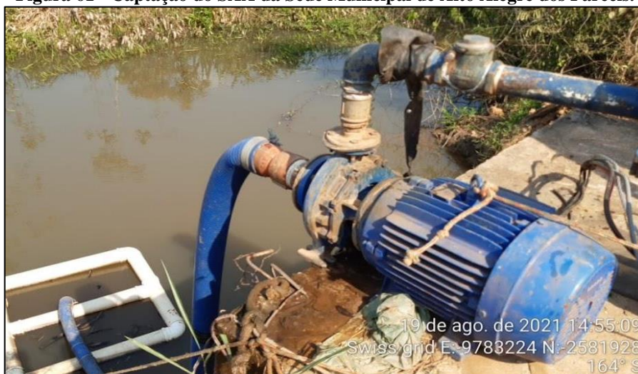
Figura 61 - Captação do SAA da Sede Municipal de Alto Alegre dos Parecis.
