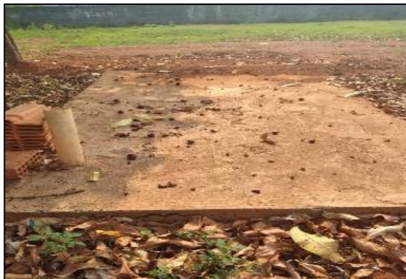
Fossa Séptica na E. M. E. F. Severino Batista Costa – Sede Municipal.
