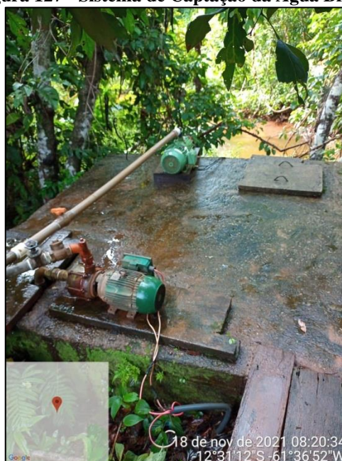
Figura 127 - Sistema de Captação da Água Bruta.
