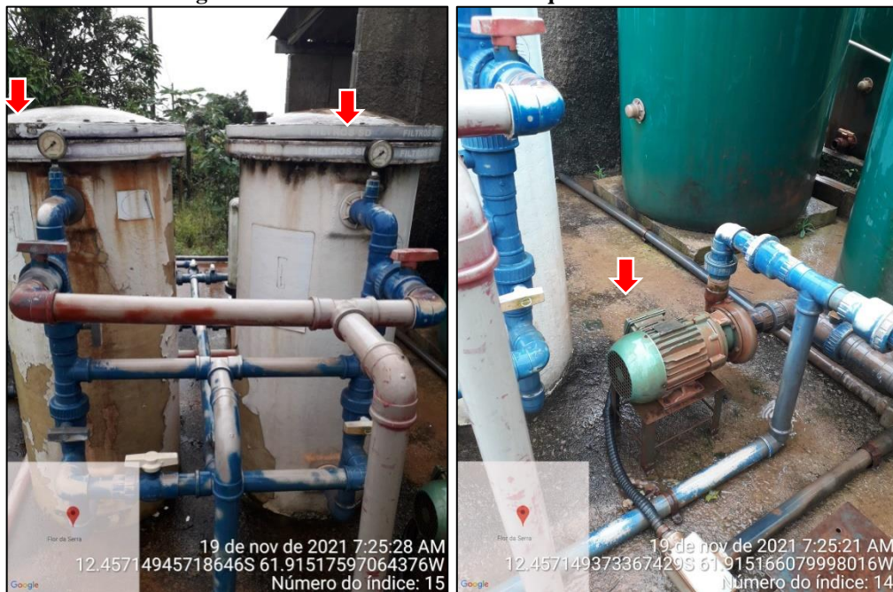
Figura 120 - Vista da Saída de Recalque e Manômetro.
