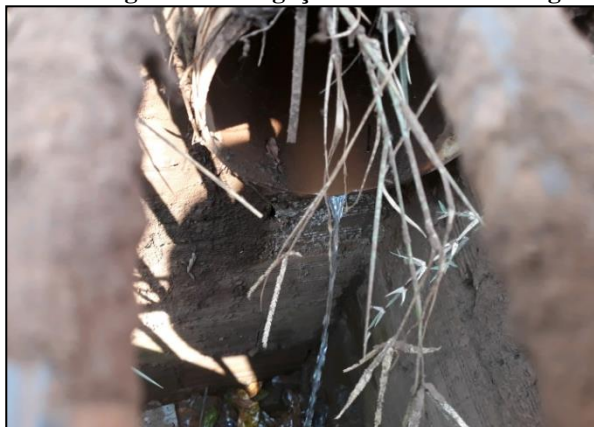
Ligação Clandestina de Esgoto. Coordenadas Geográficas: 12°07'57.25"S e 61°51'31.58"W.
