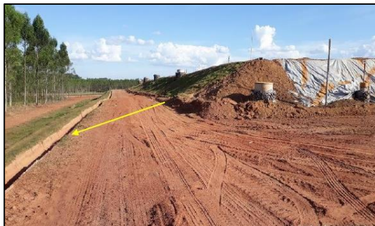
Sistema de Drenagem de Águas Superficiais.
