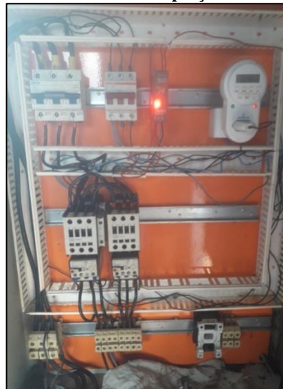
Figura 102 - Vista Externa do Painel de Captação.
