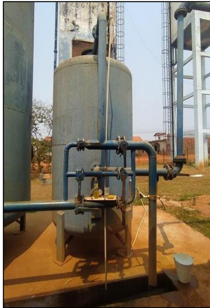
Figura 73 - Filtro da ETA da Sede Municipal.
