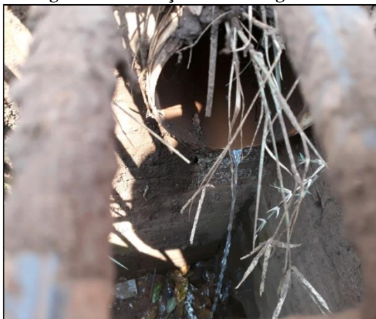
Lançamento de Esgoto no Sistema de Microdrenagem. 12°07'57.25"S e 61°51'31.58"W.
