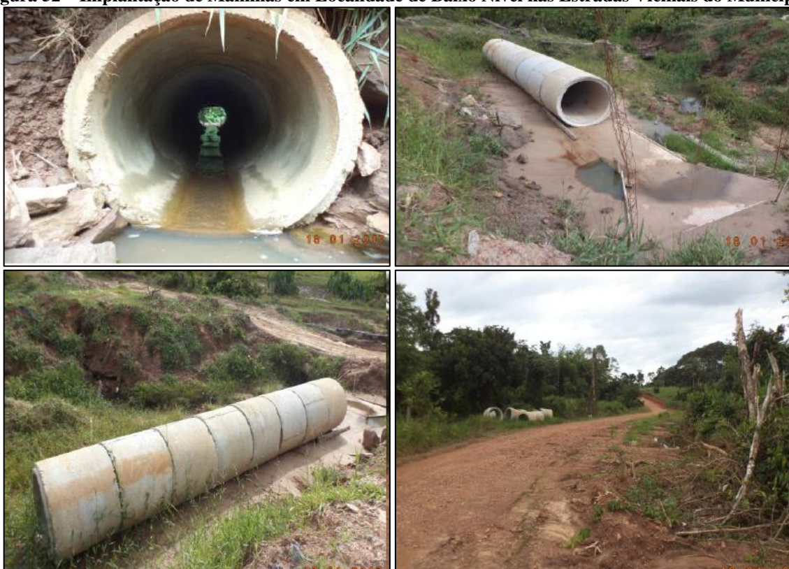
Figura 52—Implantação de Manilhas em Localidade de Baixo Nível nas Estradas Vicinais do Município.
