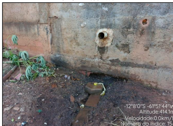
Despejo de Águas Cinzas à Céu Aberto. Coordenadas Geográficas: 12°08'00.00"S e 61°51'44.00"W.
