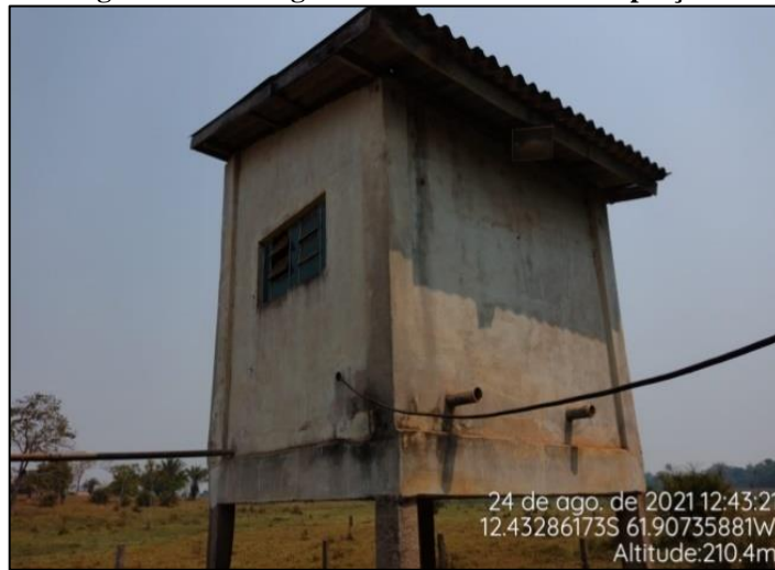
Figura 100 - Abrigo do Painel Elétrico de Captação.
