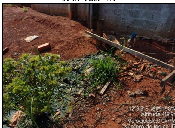
Despejo de Águas Cinzas à Céu Aberto. Coordenadas Geográficas: 12°08'00.00"S e 61°51'44.00"W.
