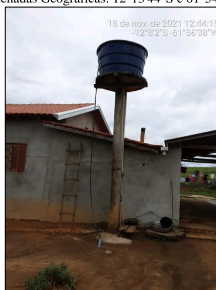
Linha P 70, km 8 – Caixa de Reservação (500 Litros).
