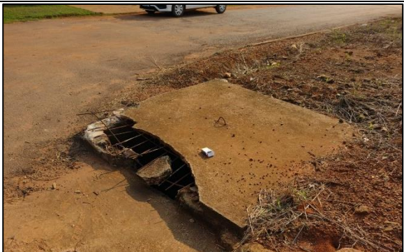
Dispositivo com Tampa Quebrada, na Rua Tiradentes. -12.128858595S; -61.85784647W.
