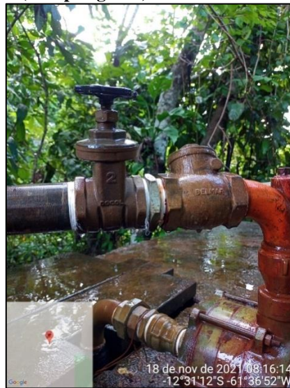
Figura 133 - Registro (de 2 polegadas) do Sistema de Adução de Água Bruta.
