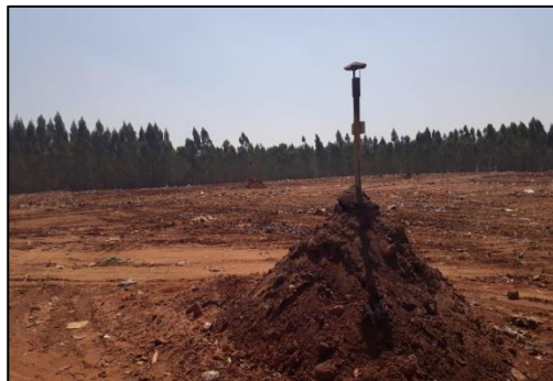
Sistema de Drenagem de Gás e de Líquido Percolado (chorume).
