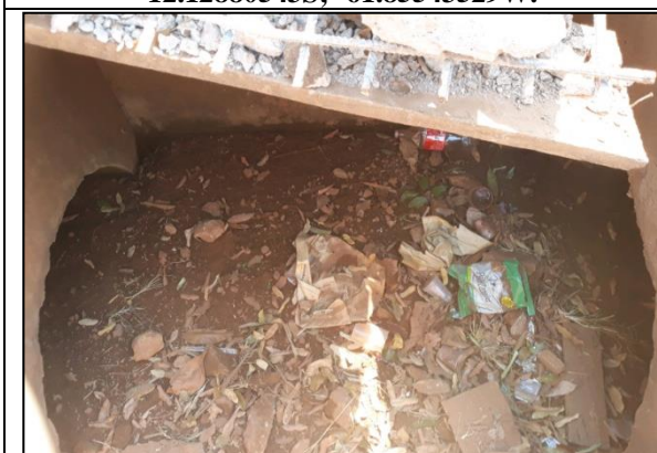
Dispositivo com Tampa Quebrada e Acúmulo de Resíduos no Interior, na Av. Tancredo de Almeida Neves. 12°07'57.48"S e 61°51'43.92"W.
