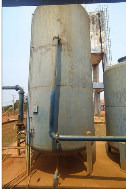
Figura 71 - Floculador Decantador da ETA da Sede Municipal.
