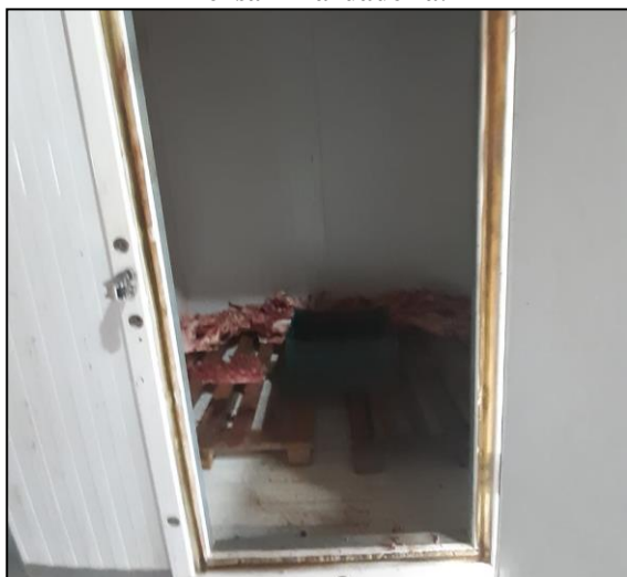
Câmara Fria, Vista Interna.
