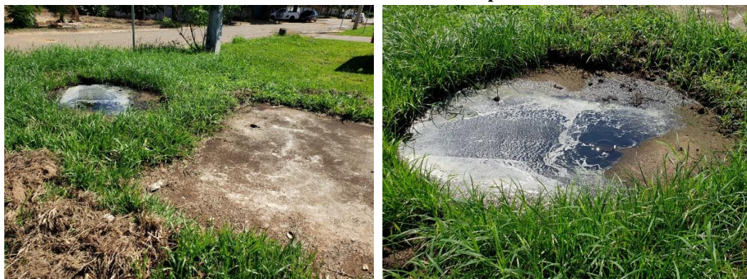
Figura 129 - Fossa rudimentar da Prefeitura Municipal, Vigilância Sanitária e SEMSAU - com sinais de extravasamento - Sede Municipal
