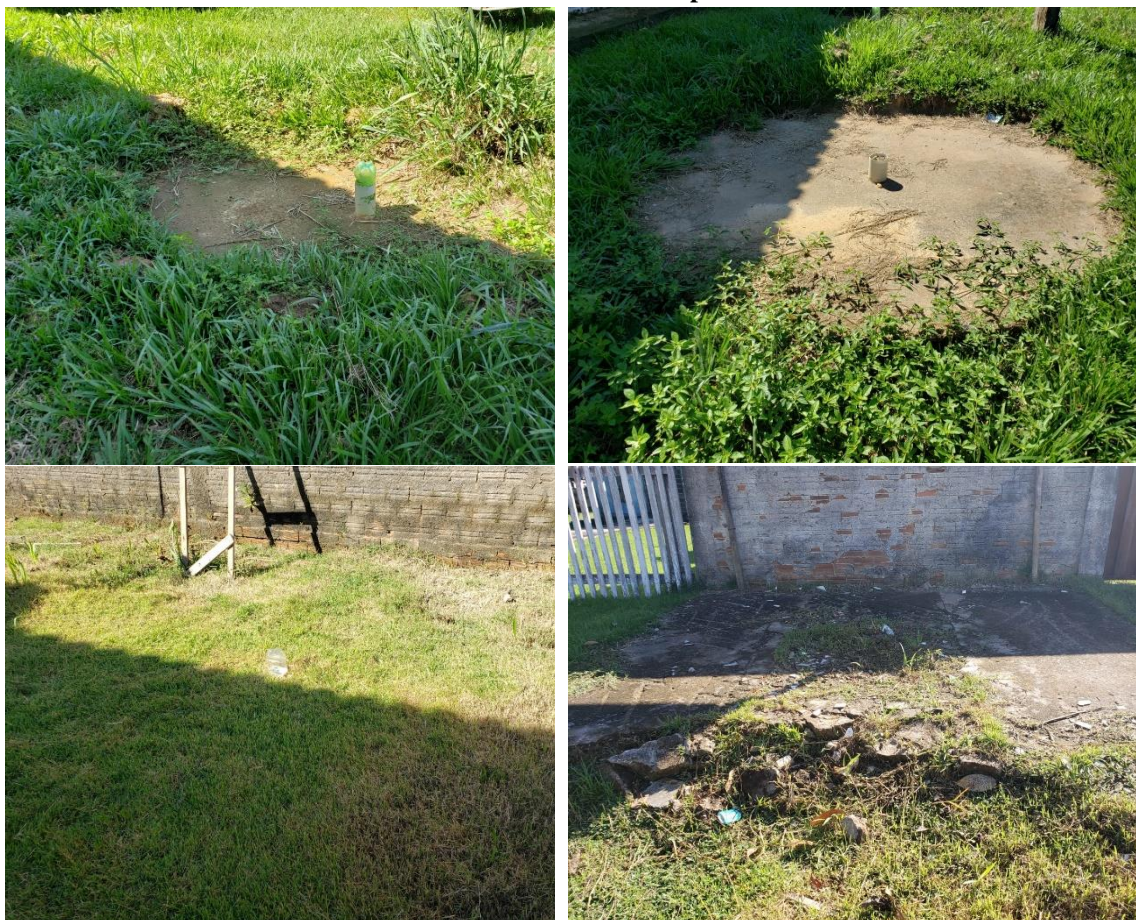
Figura 132 - Fossas rudimentares da Escola Municipal de Ensino Fundamental Professor Ivonete Venâncio - Sede Municipal
