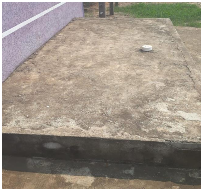
Figura 120 - Fossa rudimentar instalada na Rua Girassol, Setor 02
