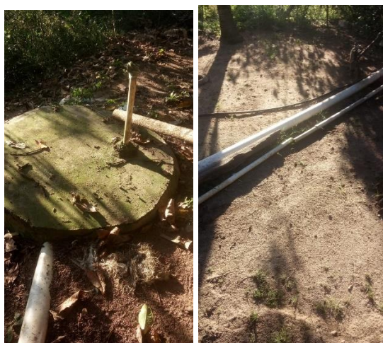
Figura 139 - Fossa rudimentar localizada em domicílio da área rural do Município
