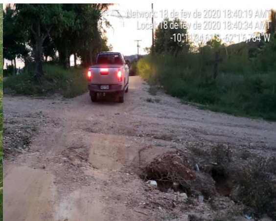
P 054 - Erosão do Pavimento, Linha 201
