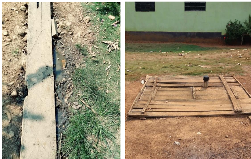
Figura 140 - Lançamento inadequado de águas cinzas a céu aberto e fossa rudimentar em mal estado de conservação
