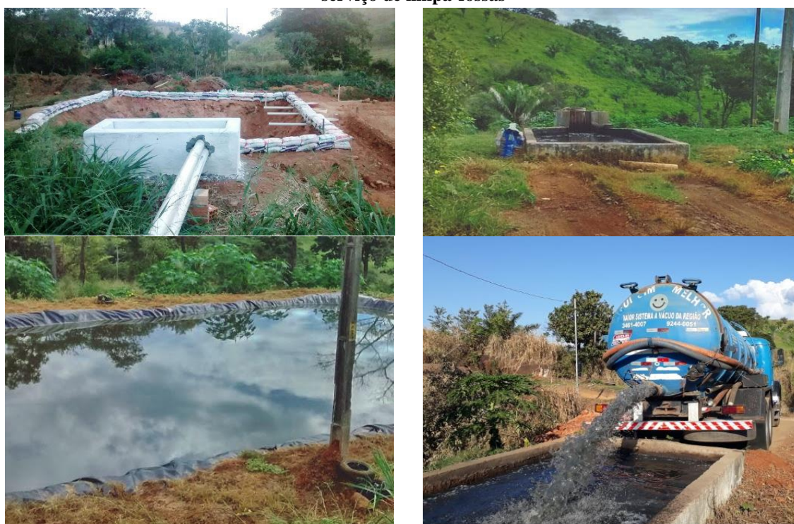
Figura 197 - Estação de Tratamento de Esgoto Simplificada construída pelas empresas prestadoras do serviço de limpa-fossas
