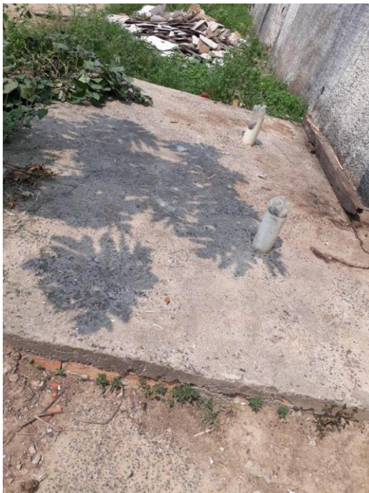
Figura 125 - Fossa rudimentar instalada no Distrito de Santa Rosa
