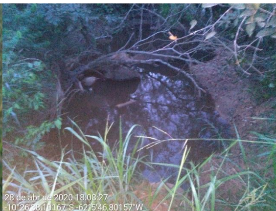
P 040 – Tubo Armco linha 201 sentido linha 153. Estado de conservação: difícil precisar o estado de conservação por conta das condições locais. Nota-se, entretanto, que a peça tem sido funcional.
