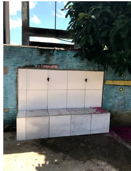
Figura 100 - Torneiras de distribuição de água
