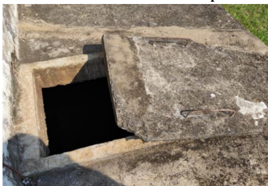
Figura 78 - Reservatório Semi-enterrado utilizado na etapa final do tratamento da água
