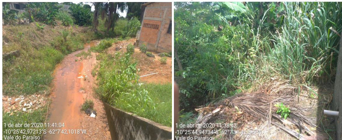
Figura 144 - Área com lançamento clandestino de águas cinzas em canais de macrodrenagem
