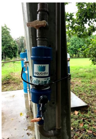
Figura 102 - Dosador de cloro
