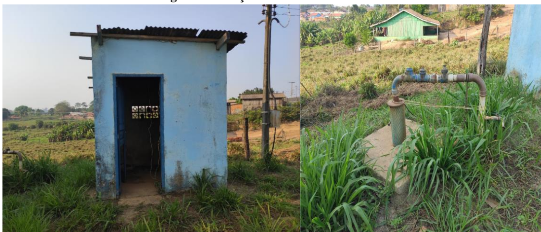
Figura 53 - Poço desativado na Linha 200
