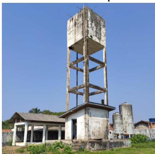
Figura 90 - Reservatório Elevado utilizado para a distribuição da água
