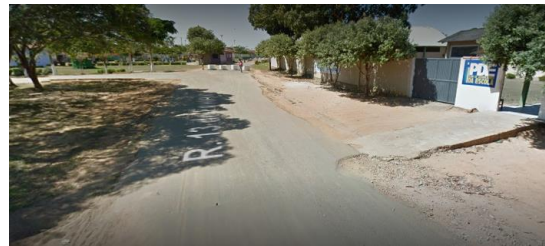
Pavimentação sem meio-fio
