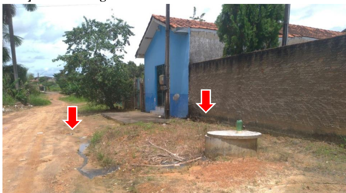
Figura 39 - Lançamento de águas cinzas e uso de fossa rudimentar na Rua Primavera
