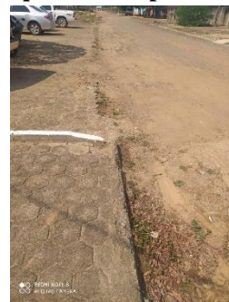
Pavimentação sem meio-fio
