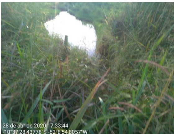
P 039 – Tubo de concreto linha 201 sentido 153. Estado de conservação: o tubo encontra-se submerso por isso não é possível precisar seu estado de conservação. Nota-se vegetação alta no entorno da entrada do tubo, o que causa entupimentos e perda/diminuição da capacidade de drenagem do aparelho.
