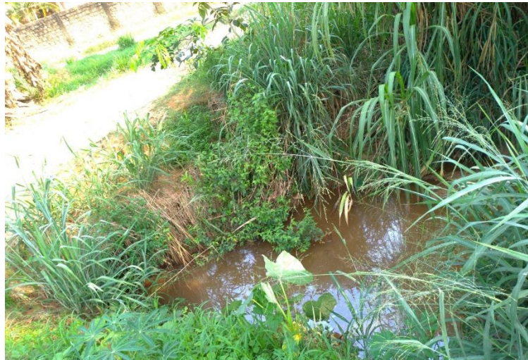
F07 - Bueiro Rua Primavera 10°42'91.66"S e 62°12'96.42"W Tubo de concreto Mal estado de conservação
