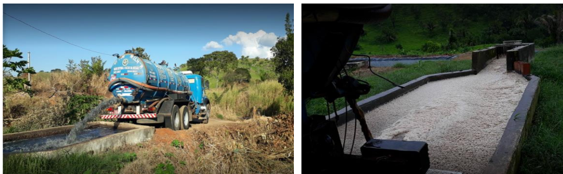
Figura 127 - Estação de Tratamento de Esgoto da Empresa Ricardo Auto Fossa de Outro Preto d'Oeste/RO
