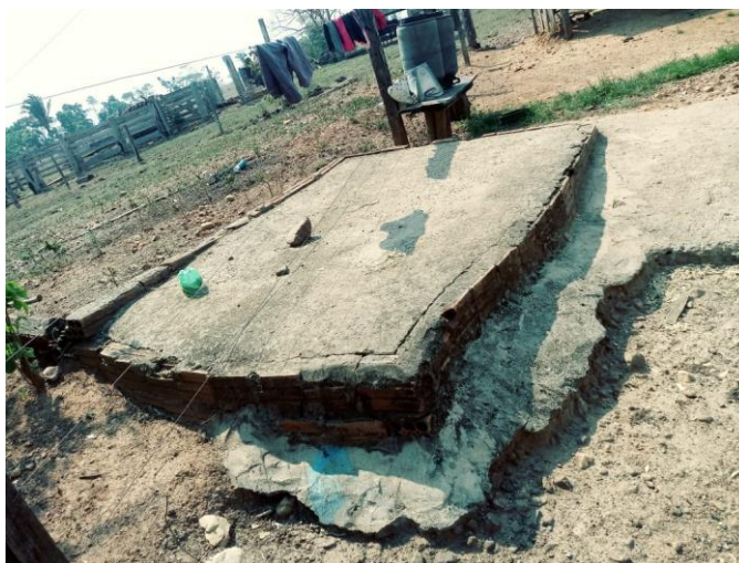
Figura 137 - Fossa rudimentar localizada em domicílio da área rural do Município
