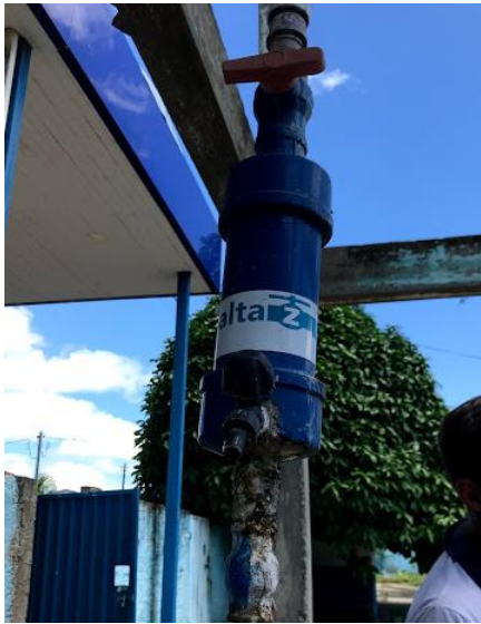
Figura 97 - Dosador de Cloro
