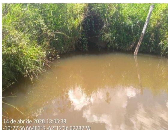
P 017- Tubo Arco (Linha 62) Estado de conservação: Apresenta bom estado de conservação, com nenhum sinal de oxidação, fendas, buracos ou demais desgastes em sua estrutura.
