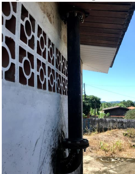
Figura 89 - Adutora de água tratada
