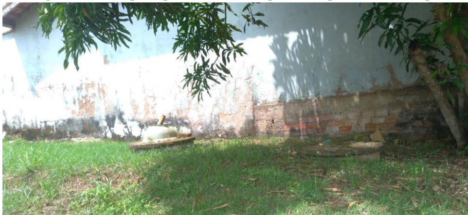
Figura 122 - Tanque Séptico e Sumidouro próximo a prefeitura municipal
