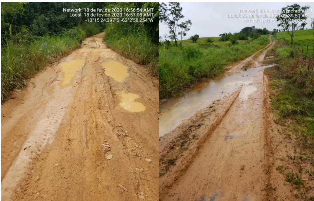
P 055- Falta de Drenagem no Pavimento, próximo a uma ponte de madeira, linha 201
