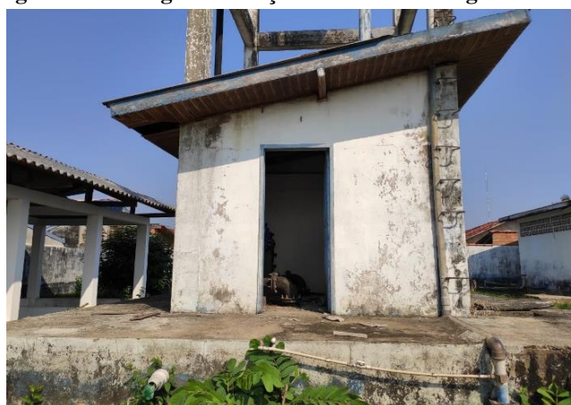
Figura 85 - Abrigo da Estação Elevatória de Água Tratada
