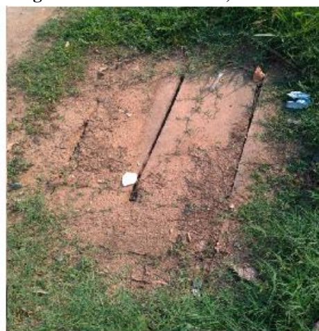
Figura 163 - Boca de Lobo, Rua 13 de Fevereiro
