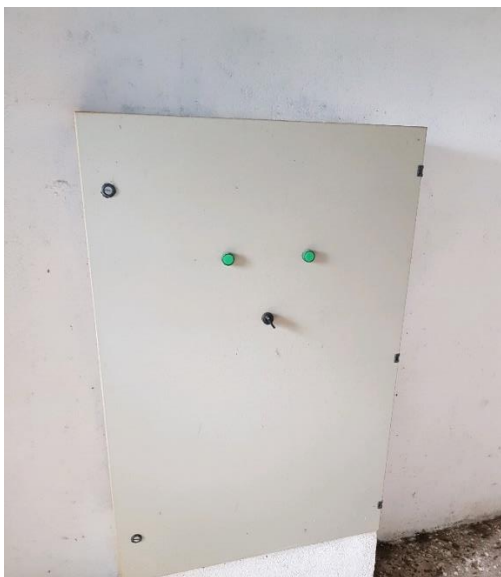
Figura 65 – Vista Externa do Painel de Comando
