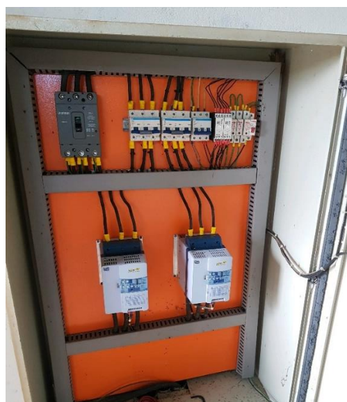
Figura 66 – Vista Interna do Painel de Comando
