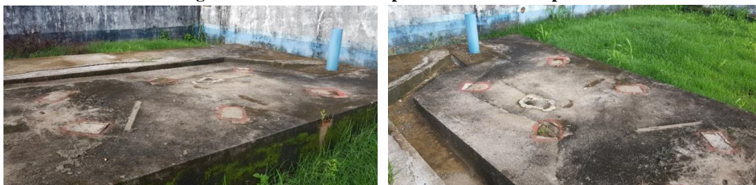
Figura 76 - Canaleta de dispensa do lodo de limpeza
