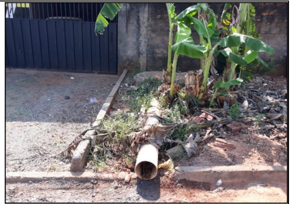
Lançamento de águas cinzas em sarjeta. Coordenadas: 11°55'25.69"S; 61°59'14.70"O.
