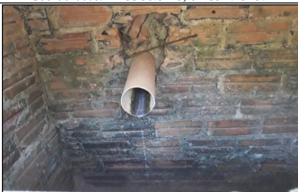
Lançamento de esgoto em boca de lobo.
