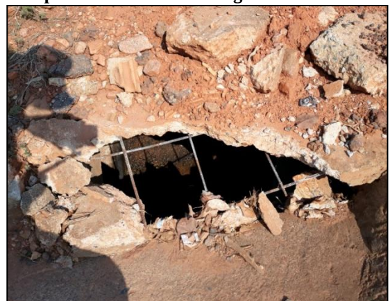
Tampa de boca de lobo quebrada, na Sede Municipal de Alta Floresta D'Oeste.
