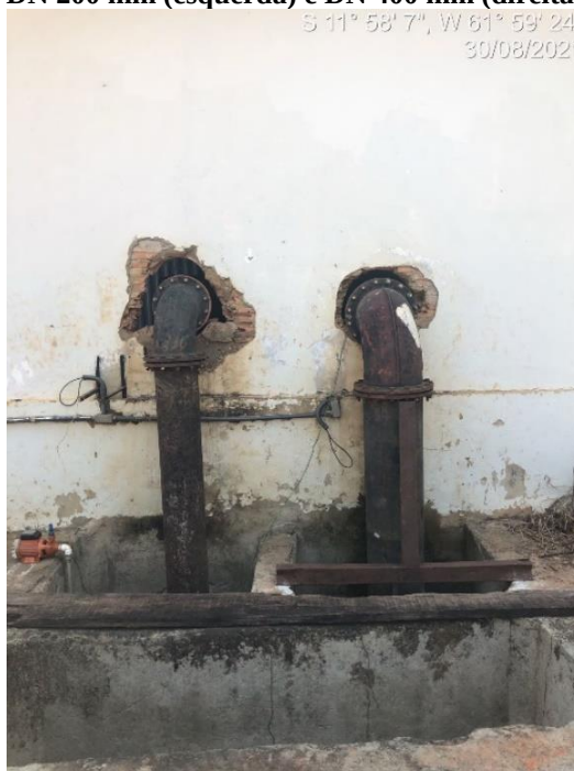
Figura 89 - Poço de sucção de água por dois conjuntos moto bomba – Adutoras em material ferro fundido DN 200 mm (esquerda) e DN 400 mm (direita)
