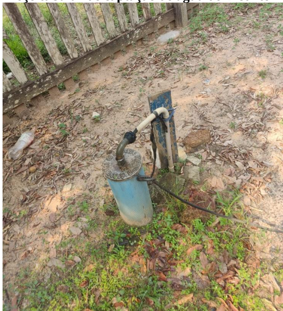
Figura 138 – Poço tubular de captação de água do Distrito Izidolândia
