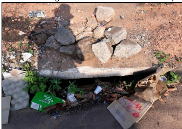
Acúmulo de resíduos sólidos em sarjeta e entulho na tampa da boca de lobo, na Sede Municipal de Alta Floresta D'Oeste.
