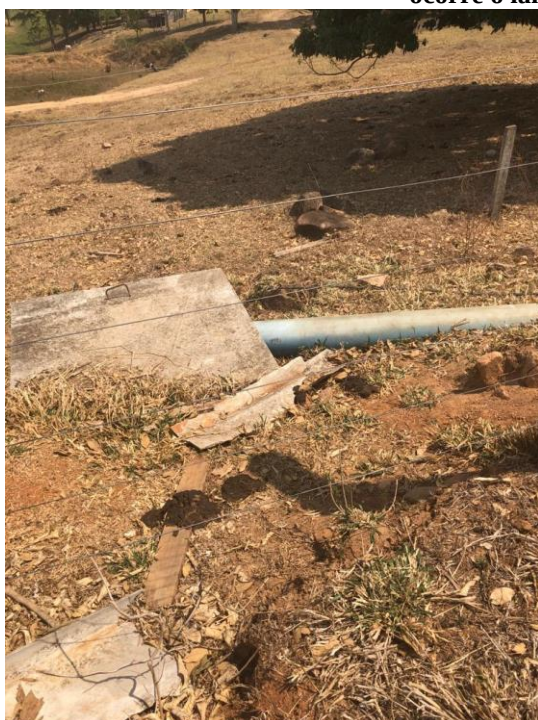
Figura 100 - Tubulação que conduz as águas de lavagem e descarga da ETA (esquerda) e represa onde ocorre o lançamento (direita)
