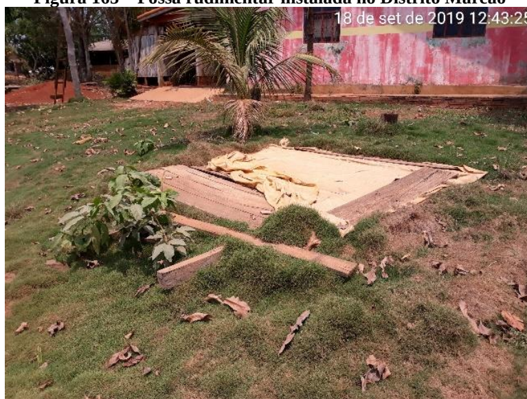
Figura 165 – Fossa rudimentar instalada no Distrito Marcão
