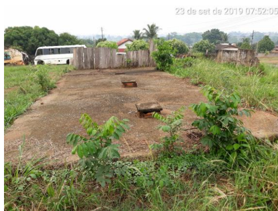
Fossa séptica do Hospital Municipal (sede)
