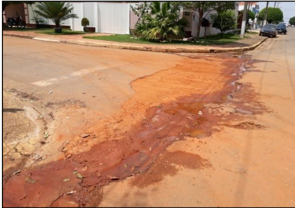
Erosão causada por água servida.
