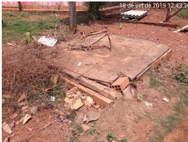
Figura 162 – Fossa rudimentar instalada no Distrito Santo Antônio
