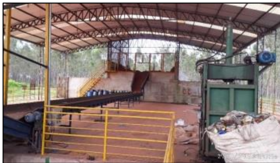
Central de Triagem de Materiais Recicláveis
