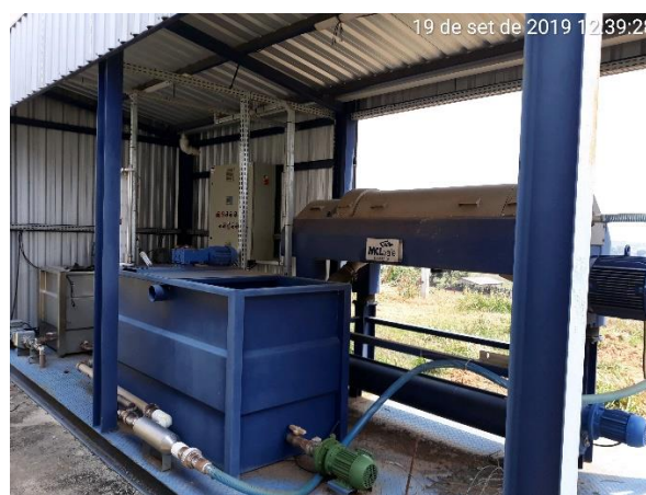
Equipamento de secagem e tratamento do lodo proveniente da lavagem da ETA
