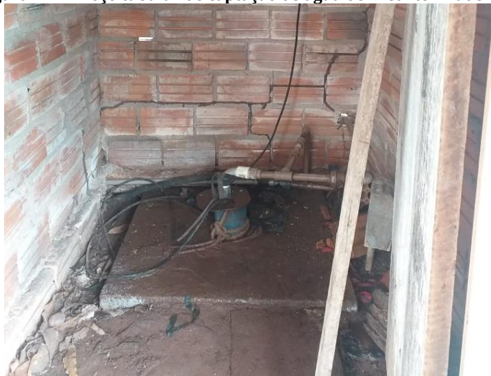
Figura 122 – Poço tubular de captação de água do Distrito Filadélfia
