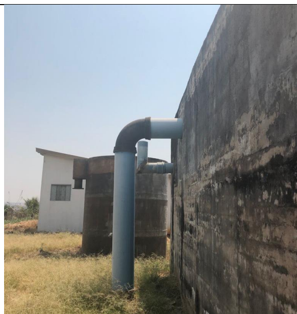
Tubulação de entrada da água no reservatório apoiado – Material PVC DN = 400 mm
