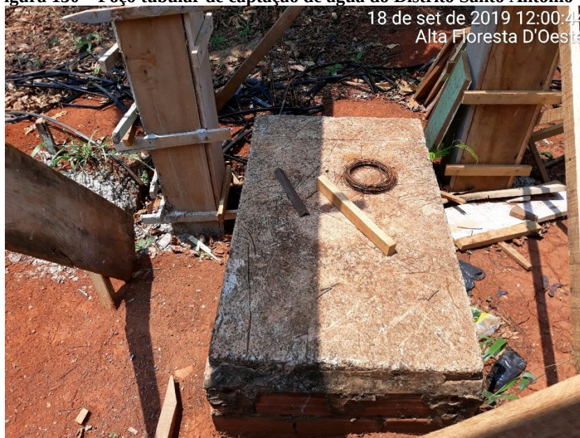
Figura 130 – Poço tubular de captação de água do Distrito Santo Antônio
