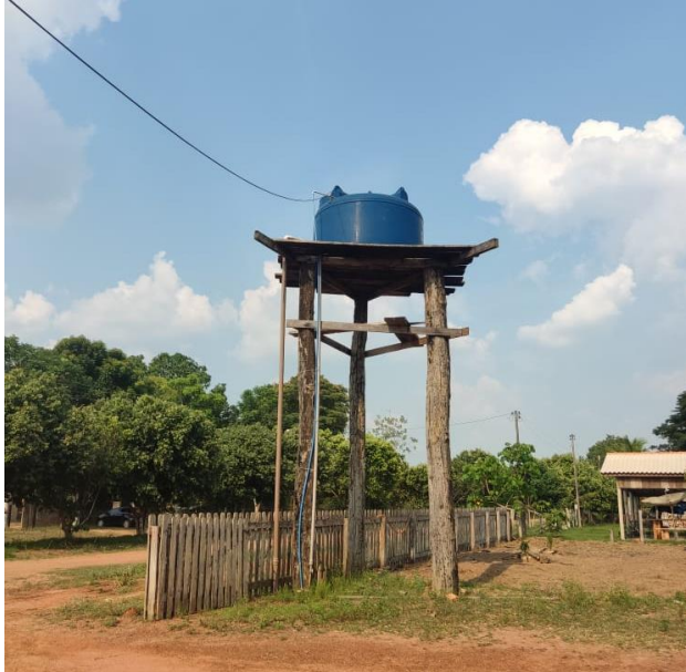
Figura 140 – Reservatórios de água do Distrito Izidolândia
