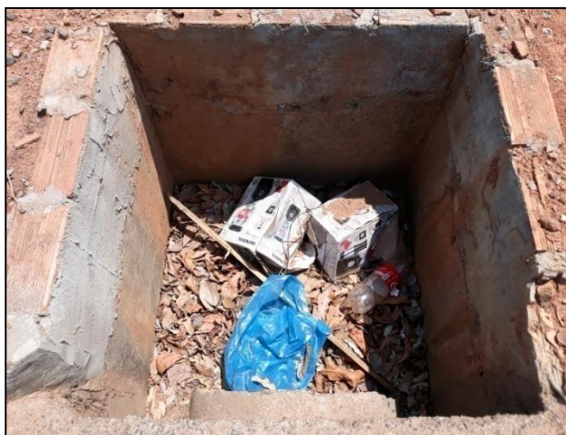
Dispositivo sem tampa e com resíduos sólidos em seu interior, na Sede Municipal de Alta Floresta D'Oeste.
