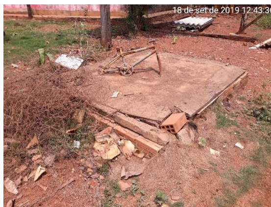
Fossa Rudimentar do Distrito Santo Antônio
