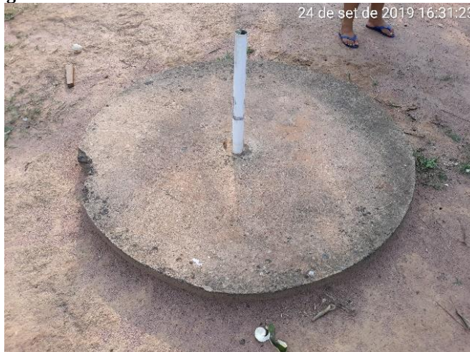
Figura 161 – Fossa rudimentar instalada no Distrito Filadélfia
