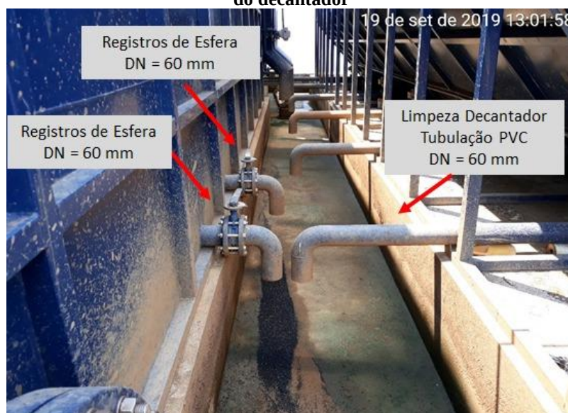
Figura 99 - Registros de Esferas utilizados na limpeza manual dos filtros de areia e tubulações de limpeza do decantador
