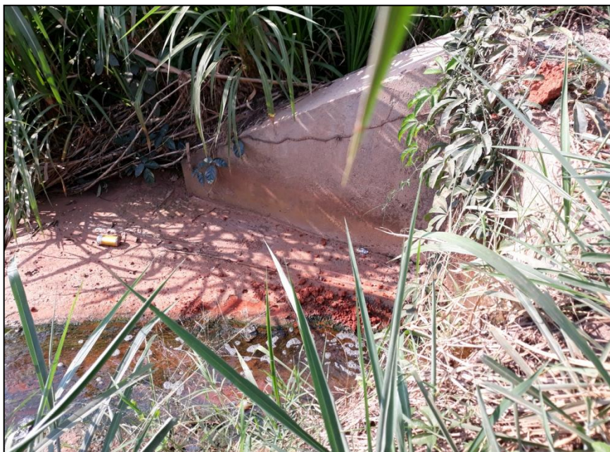
L5 - Lançamento de águas pluviais em várzea. Coordenadas: 11°55'24.52"S e 61°59'43.96"O.
