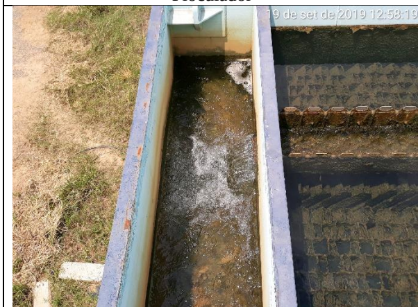
Local de saída da água clarificada
