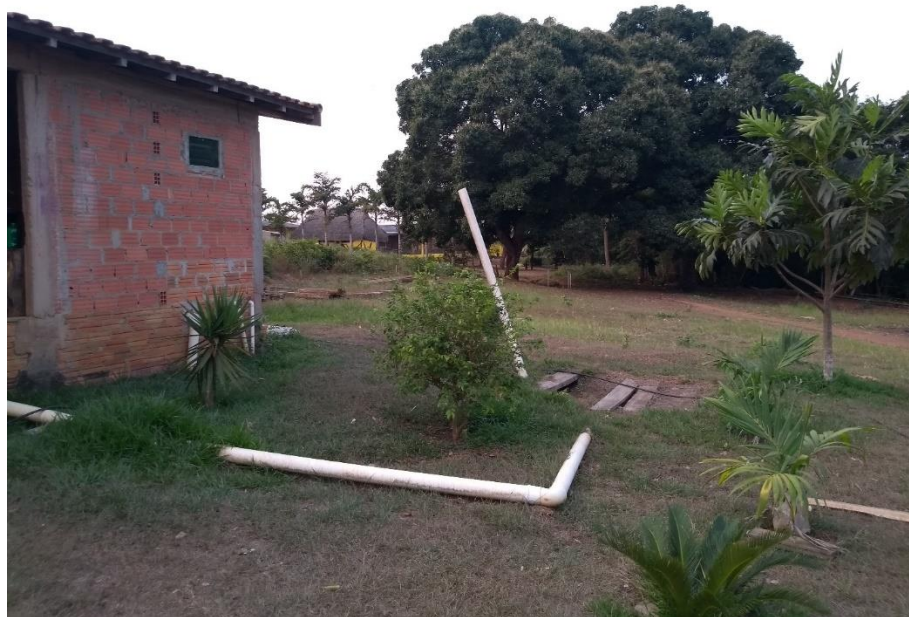
Figura 40 - Canalização do esgoto sanitário para fossas rudimentares – Distrito de Rolim de Moura do Guaporé
