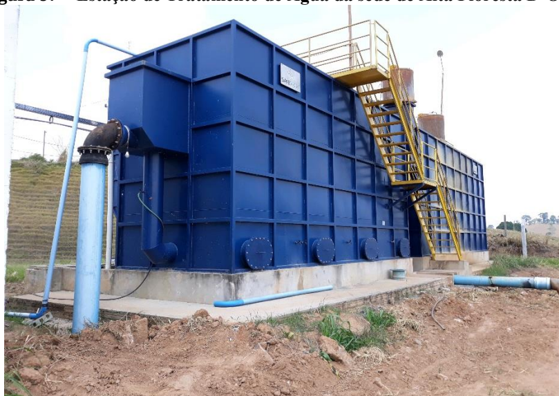
Figura 97 – Estação de Tratamento de Água da sede de Alta Floresta D'Oeste
