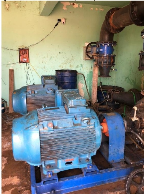
Figura 91 - Conjuntos Moto Bomba (CMB) no interior do abrigo
