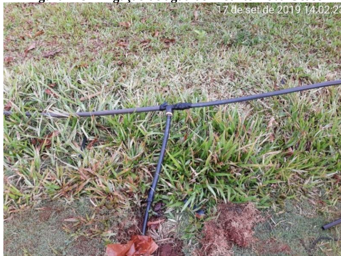
Figura 119 – Ligação de água do Distrito Nova Gease
