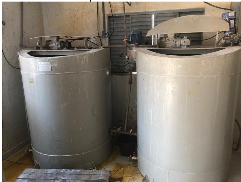
Figura 106 - Estrutura de Preparo do sulfato na ETA de Alta Floresta D'Oeste
