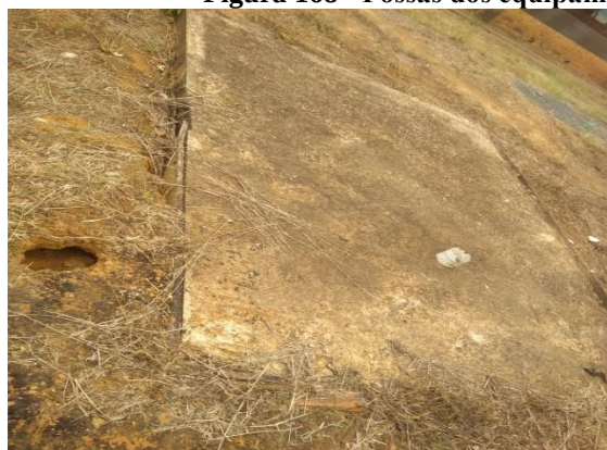
Fossa Séptica da EMEIEF Boa Esperança (Distrito Marcão)
