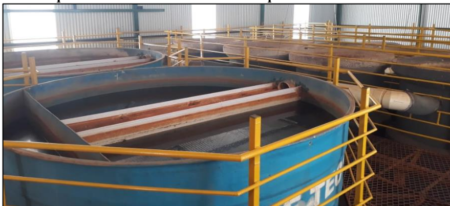
Figura 240 - Tanques utilizados no tratamento físico-químico de lixiviados do aterro sanitário.
