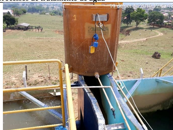
Adição do Sulfato de Alumínio na Calha Parshall
