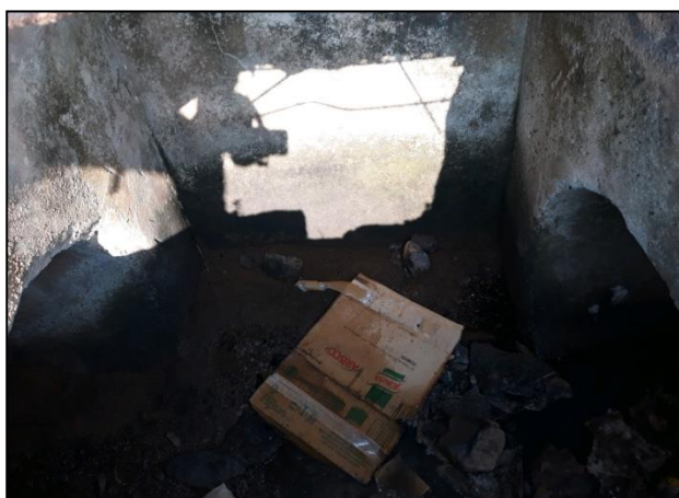
Boca de lobo com resíduos, entulhos e esgoto, na Sede Municipal de Alta Floresta D'Oeste.
