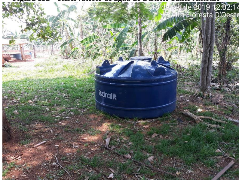
Figura 132 – Reservatório de água do Distrito Santo Antônio
