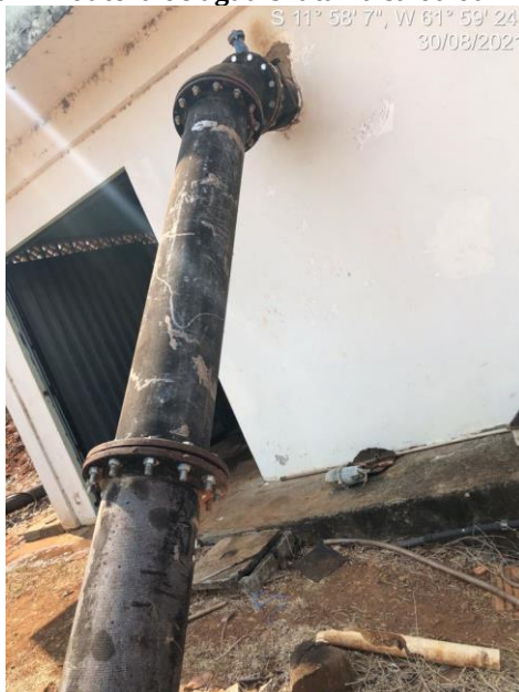
Figura 94 - Adutora de água bruta na saída da EEAB
