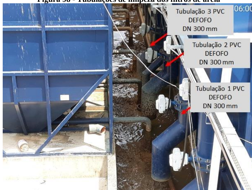
Figura 98 - Tubulações de limpeza dos filtros de areia
