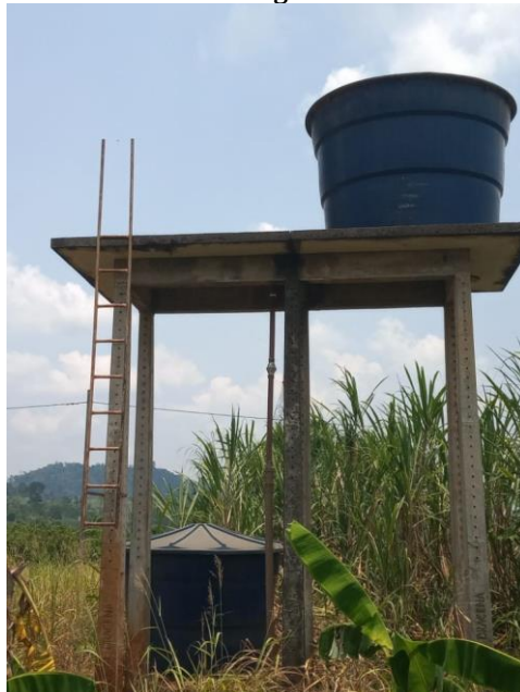
Figura 116 – Reservatórios de água do Distrito Nova Gease
