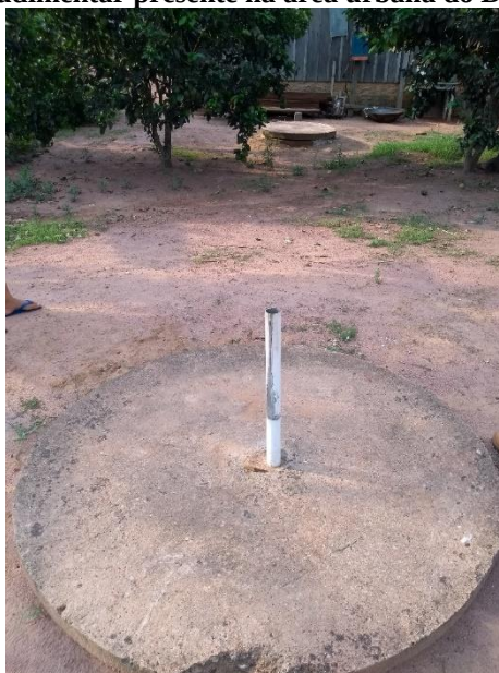
Figura 61- Fossa rudimentar presente na área urbana do Distrito de Filadélfia.
