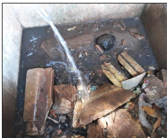
Lançamento de esgoto em boca de lobo da Sede Municipal de Alta Floresta D'Oeste.
