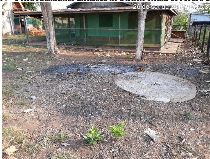
Figura 164 – Fossa rudimentar instalada no Distrito Rolim de Moura do Guaporé
