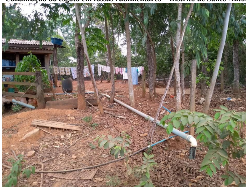
Figura 35- Canalização do esgoto em fossas rudimentares – Distrito de Santo Antônio d'Oeste
