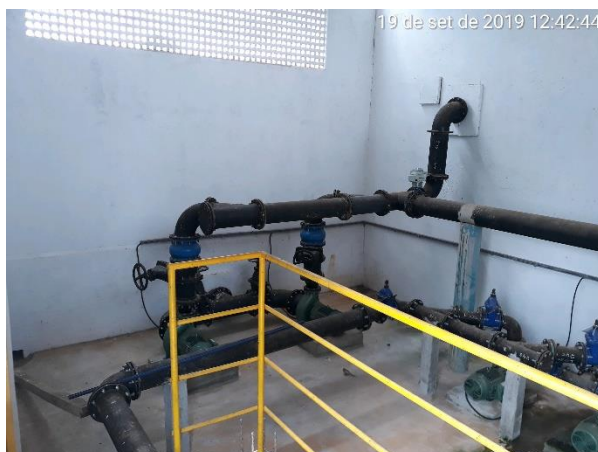
Estação Elevatória de Água Tratada
