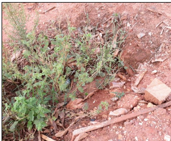
L17 - Lançamento de águas pluviais em vala. Manilha obstruída. Coordenadas: 11°56'14.98"S e 62°0'13.89"O.
