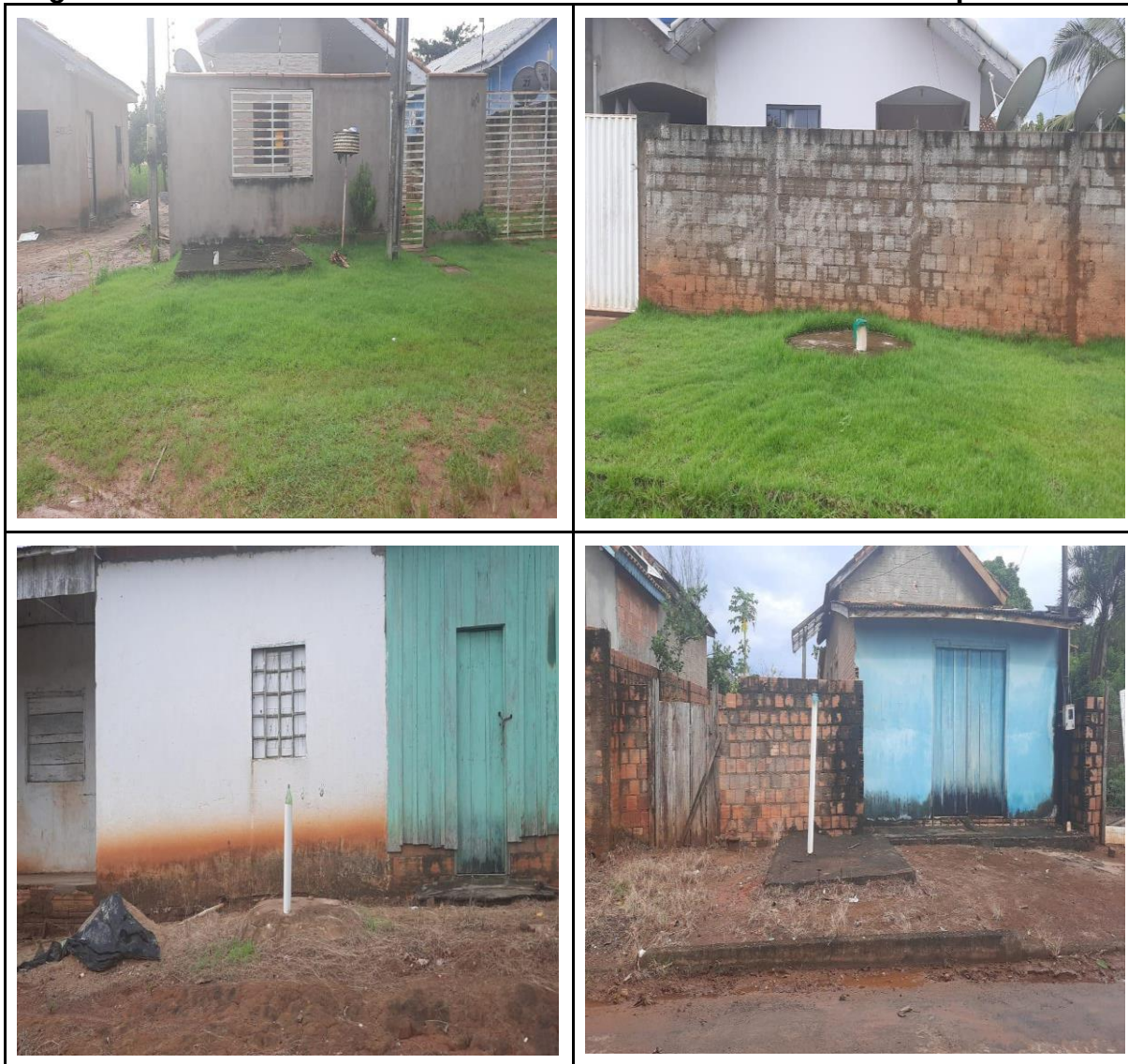
Figura X – Fossas rudimentares instaladas na área urbana de Urupá - RO.
