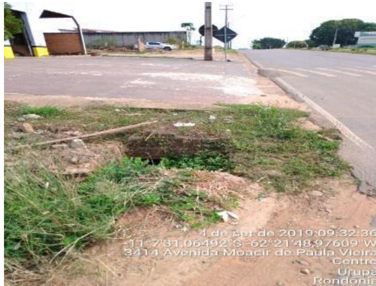
Figura 22 - Boca de lobo quebrada no município de Urupá
