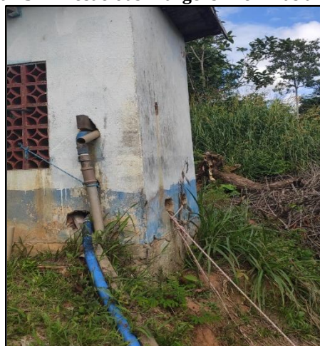
Figura 13—Erosão das Margens Próximas à EEAB.
