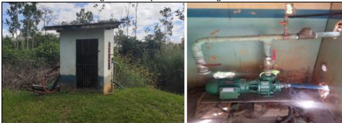
Figura 12—Estação Elevatória de Água Bruta.
