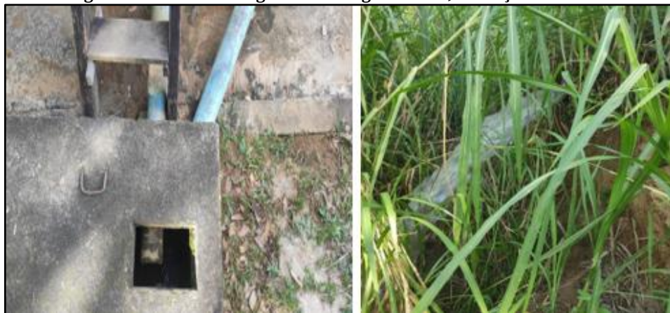
Figura 16—Água Oriunda da Lavagem e Descarga da ETA, e Lançamento no Rio Cornélio.
