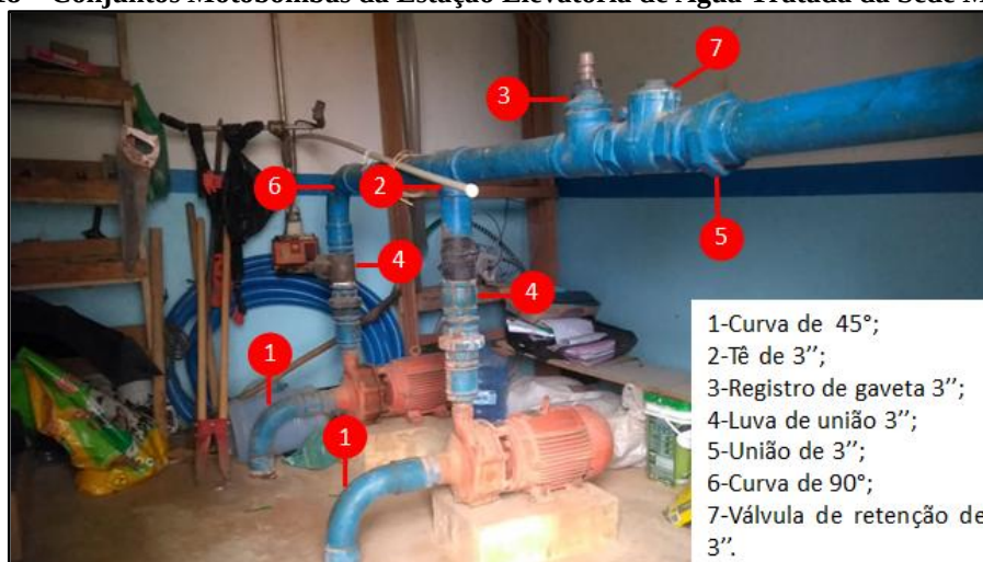
Figura 18—Conjuntos Motobombas da Estação Elevatória de Água Tratada da Sede Municipal.
