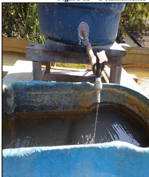
Adição do Sulfato na Calha Parshall.
