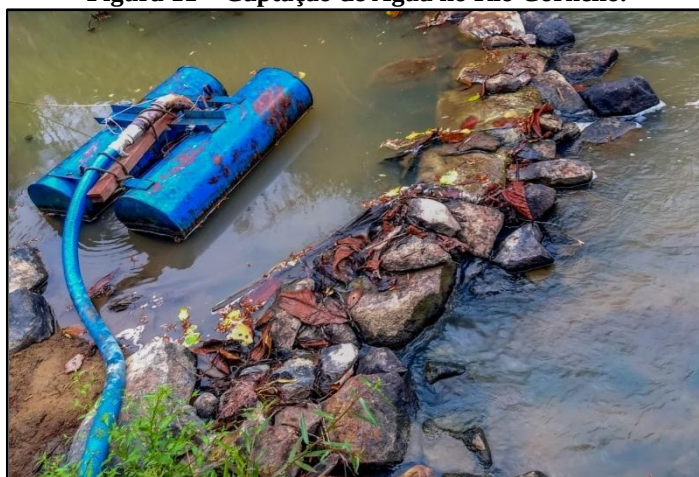
Figura 11—Captação de Água no Rio Cornélio.
