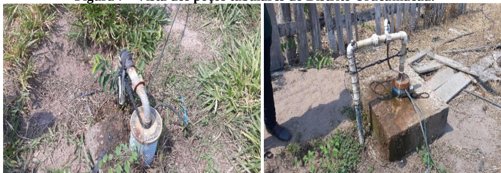
Figura 7 - Vista dos poços tubulares do Distrito Urucumacua.
