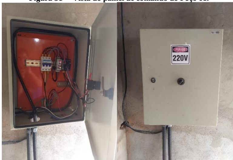
Figura 51— Vista do painel de comando do Poço 01.
