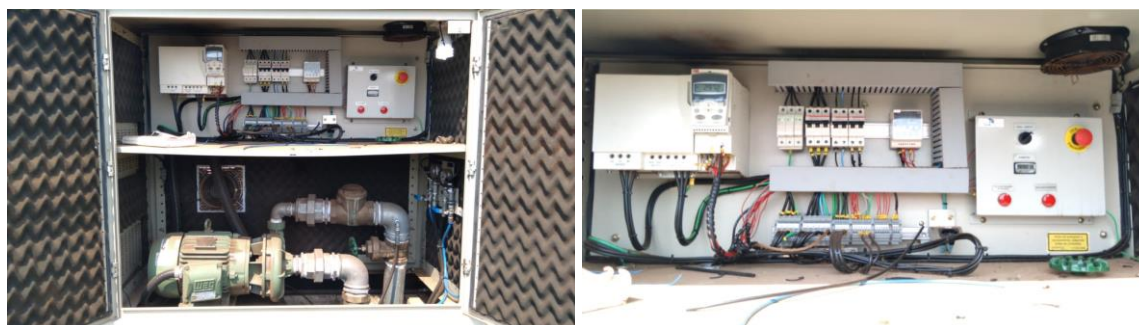
Figura 36— Painel de comando do booster.
