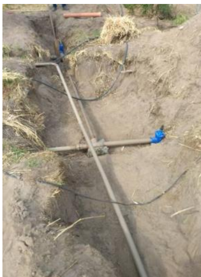
Figura 56— Adutora com os registros gaveta de Ferro Fundido DN 50 mm do SAA do Distrito Urucumacua.
