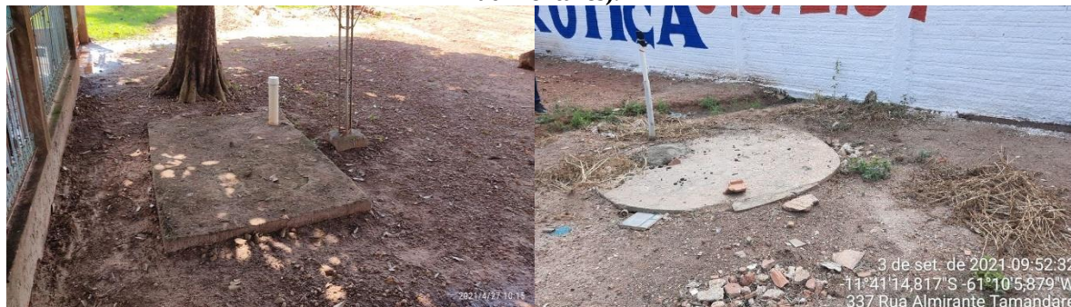
Figura 63— Soluções Alternativas Individuais de Esgotamento Sanitário na Sede Urbana (fossas rudimentares).
