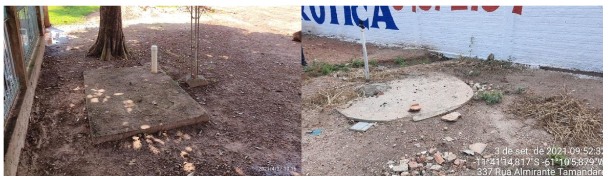
Figura 77— Fossa rudimentar na área urbana do Município de Pimenta Bueno.
