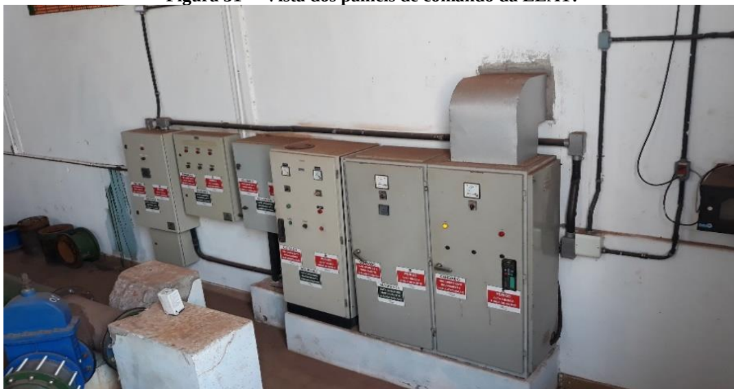
Figura 31— Vista dos painéis de comando da EEAT.
