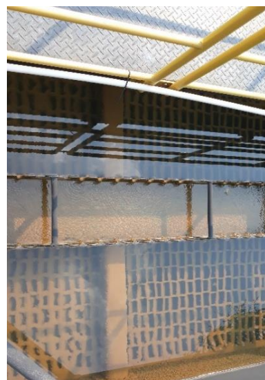
Figura 23— Detalhe da decantação de alta taxa da ETA Convencional Compacta de Pimenta Bueno.
