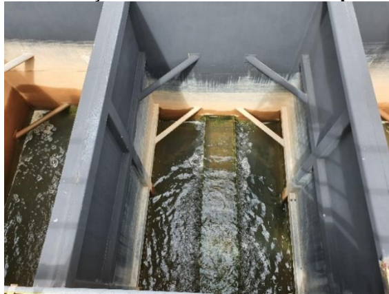
Figura 24— Detalhe da filtração da ETA Convencional Compacta de Pimenta Bueno.
