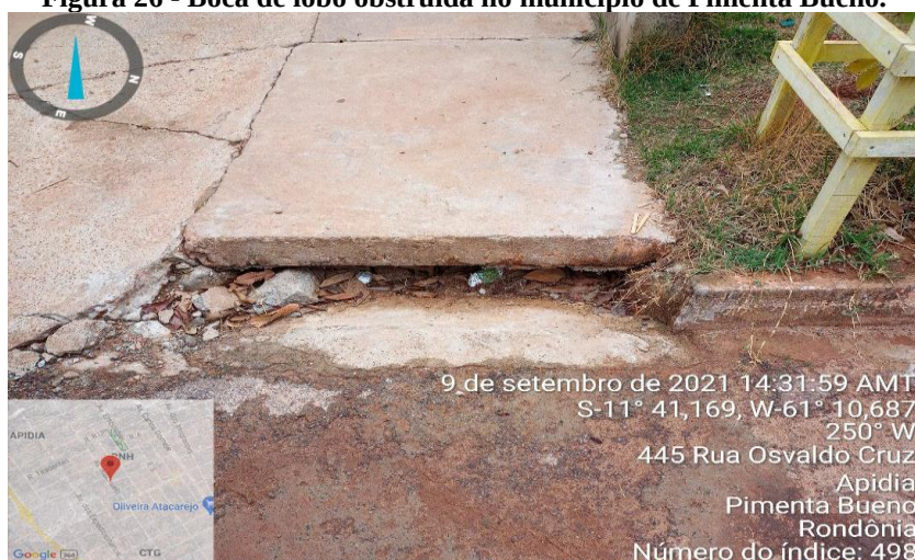
Figura 26 - Boca de lobo obstruída no município de Pimenta Bueno.
