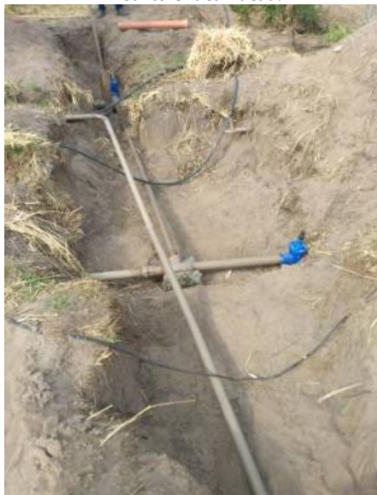
Figura 59— Registros gaveta de Ferro Fundido DN 50 mm de interligação do reservatório do SAA do Distrito Urucumacũ.
