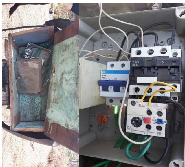
Figura 54— Vista do acionador do poço dentro da caixa de madeira.
