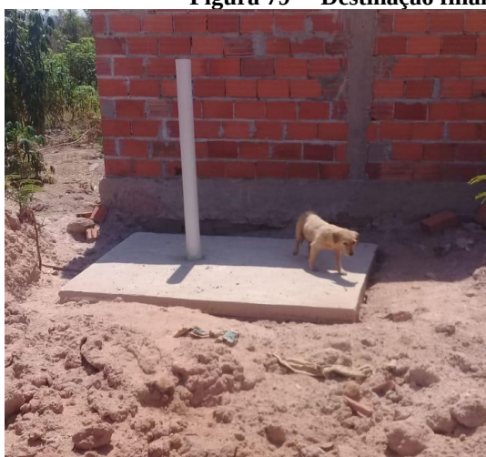
Fossa rudimentar em frente à residência
