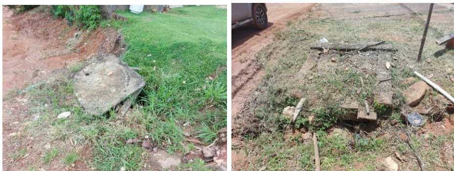
Figura 19 – Bocas de lobo obstruídas no Distrito de Rondominas.
