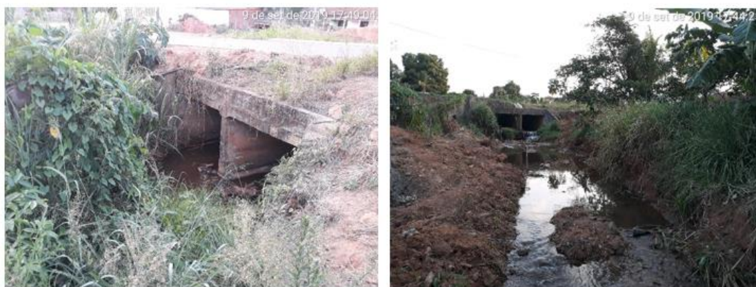
Figura 29 - Galeria e canal natural de escoamento de águas fluviais e pluviais – distrito de Migrantinópolis
