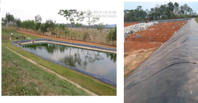
Figura 26 – Esquerda: Drenos de águas pluviais na célula. Direita: Manta de impermeabilização de base e laterais com manta de PEAD de 2,0 mm.
