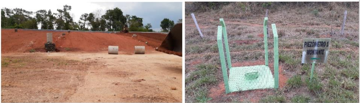
Figura 25 – Esquerda: Sistema de drenagem do efluente e de gases da célula. Direita: Piezômetro
