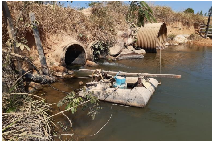
Sistema de captação de água para o abastecimento do município de Ministro Andreazza.
