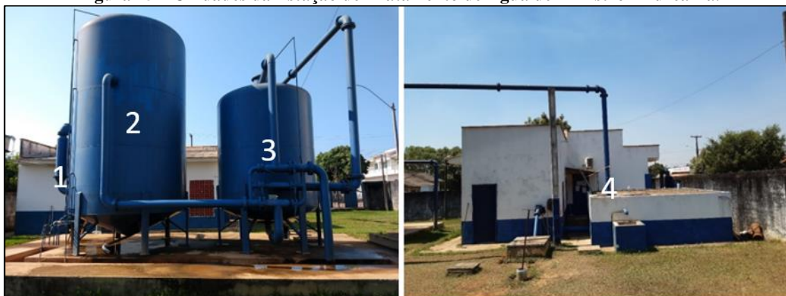
Figura 15—Unidades da Estação de Tratamento de Água de Ministro Andreazza.
