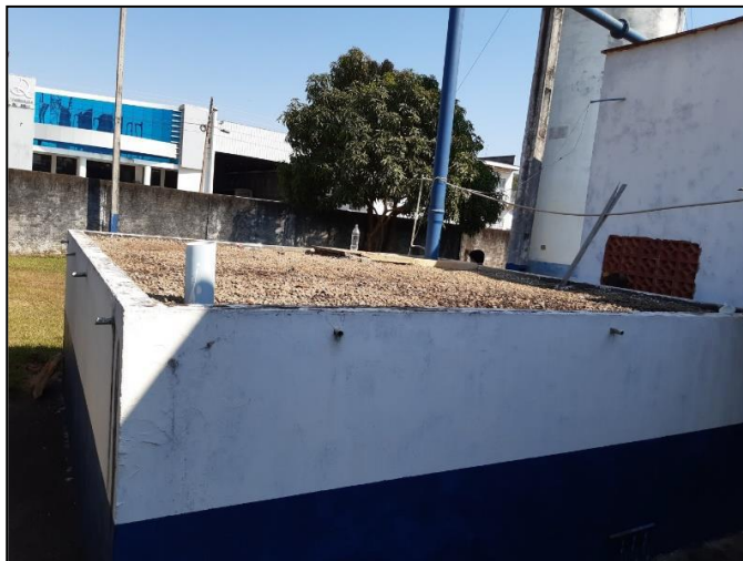
Estação de Tratamento de Água no Município de Ministro Andreazza.
