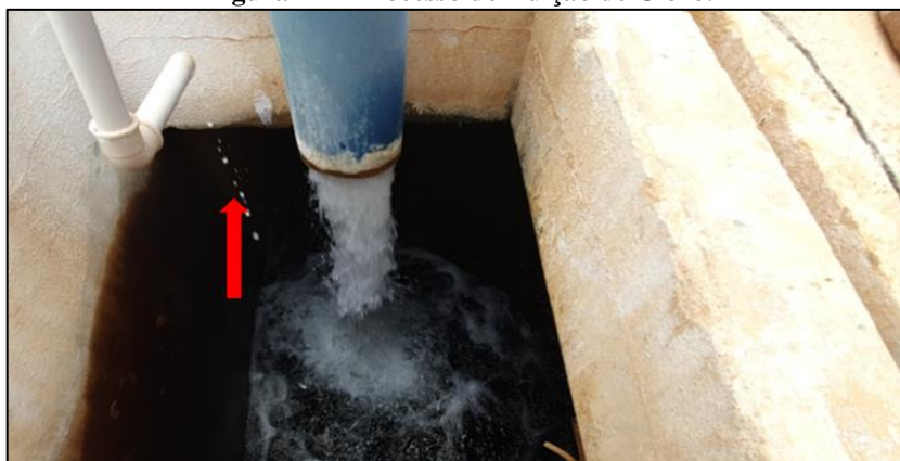
Figura 17—Processo de Adição de Cloro.
