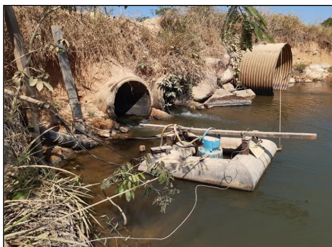
Sistema de captação de água para o abastecimento do Município de Ministro Andreazza.
