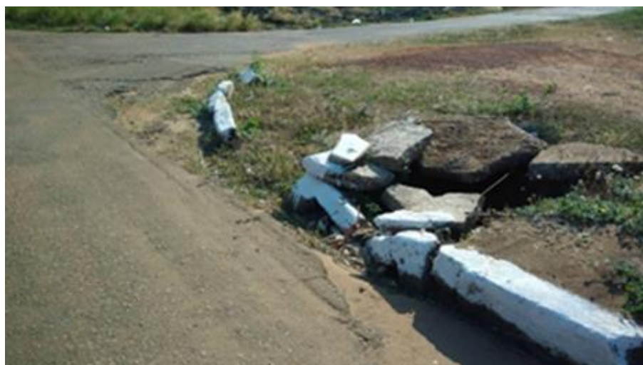
Figura 27 - Boca de lobo quebrada no municpio de Guajar-Mirim.
