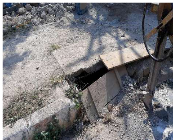
Boca de lobo quebrada e obstruída – Rua Bahia Coordenadas: 13° 7'1.95"S e 60°32'29.50"W
