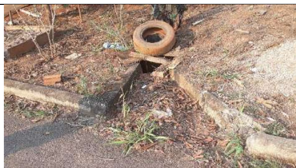
Obstruída e danificada – Rua Cerejeiras Coordenadas: 13° 7'45.91"S e 60°32'52.06"W
