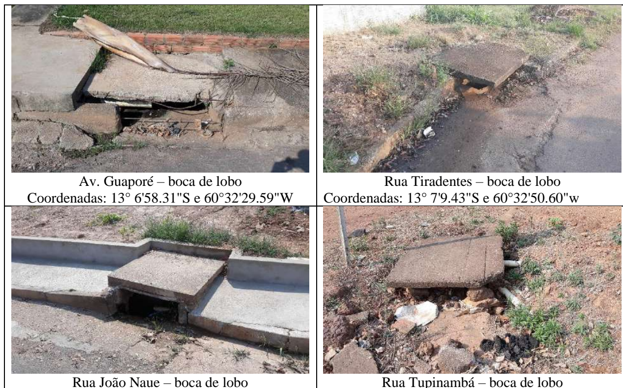
Figura 158 – Identificação de alguns pontos com lançamento de esgoto na drenagem
