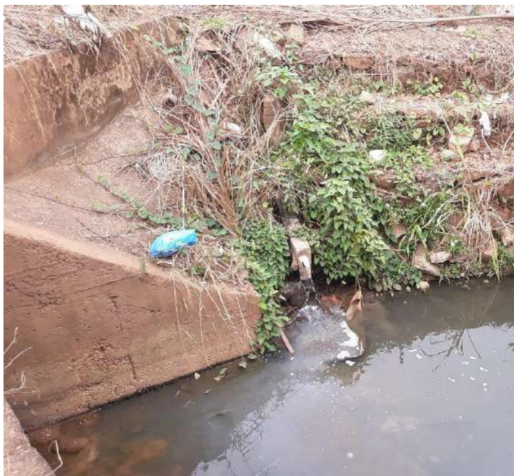
Figura 137 – Lançamento de esgoto doméstico identificado no ponto 6.
