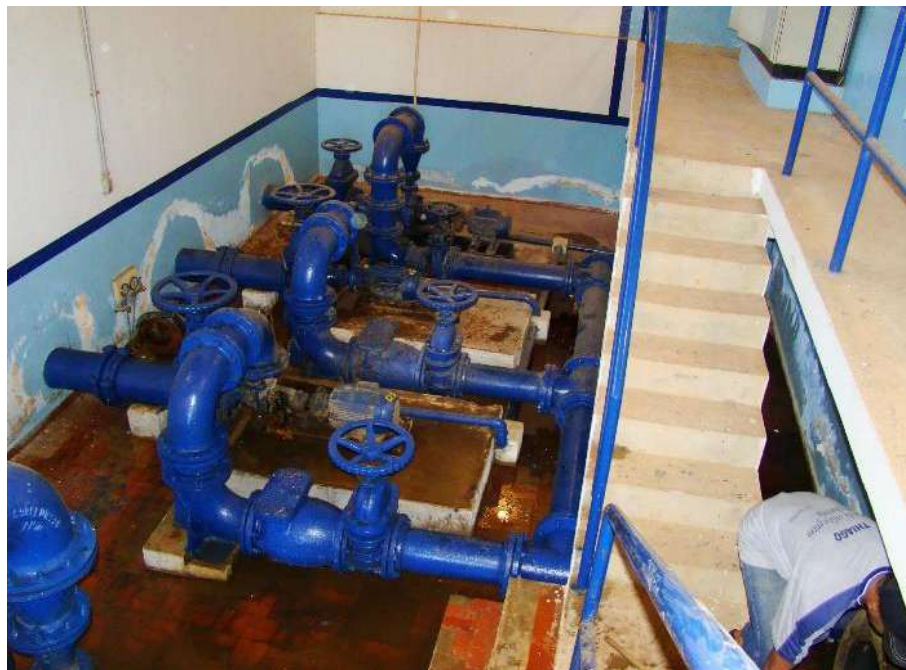
Figura 54- Conjuntos elevatórios que compõem a EEAT 3.
