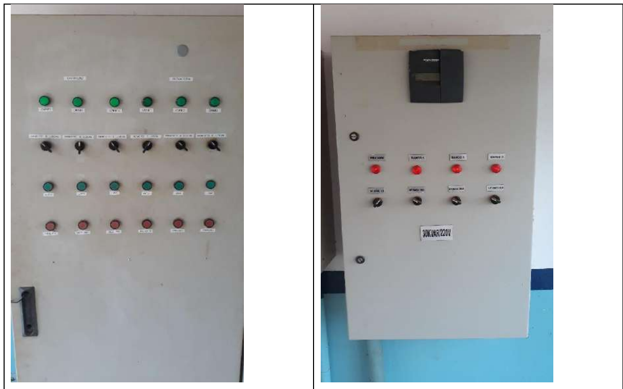
Figura 39 - Detalhes do painel de comando e de automação
