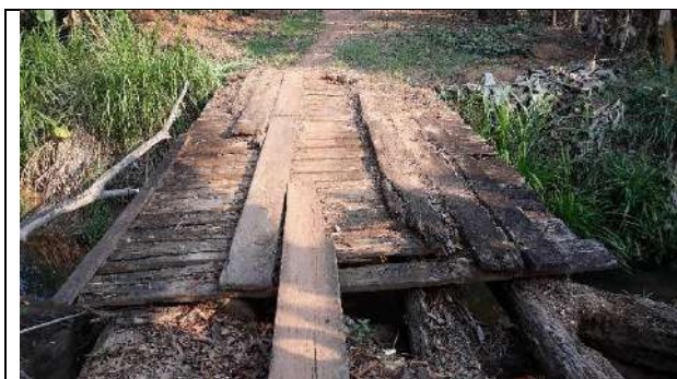
Rua Caetés – Ponte Interditada Coordenadas: 13°07'29.58"S e 61°32'08.96"W
