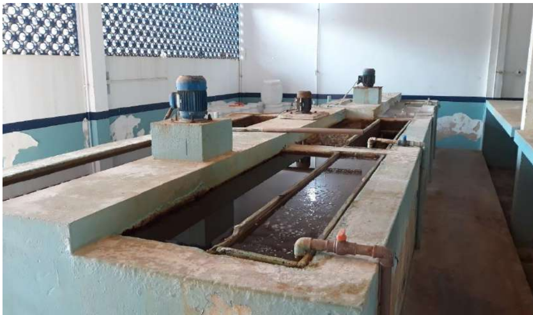
Figura 44 - Tanques para a dosagem dos químicos.
