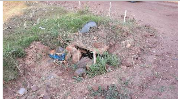
Boca simples obstruída e danificada na Rua Caetés Coordenadas: 13° 7'18.65"S e 60°32'10.45"W
