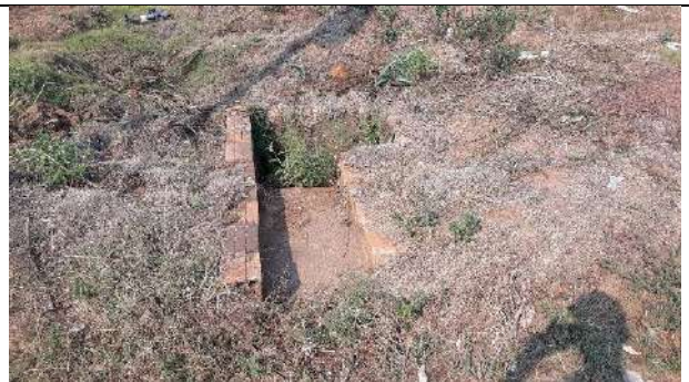
Mal Projetada e obstruída – Rua Tupinambá Coordenadas: 13° 7'16.01"S e 60°32'14.05"W
