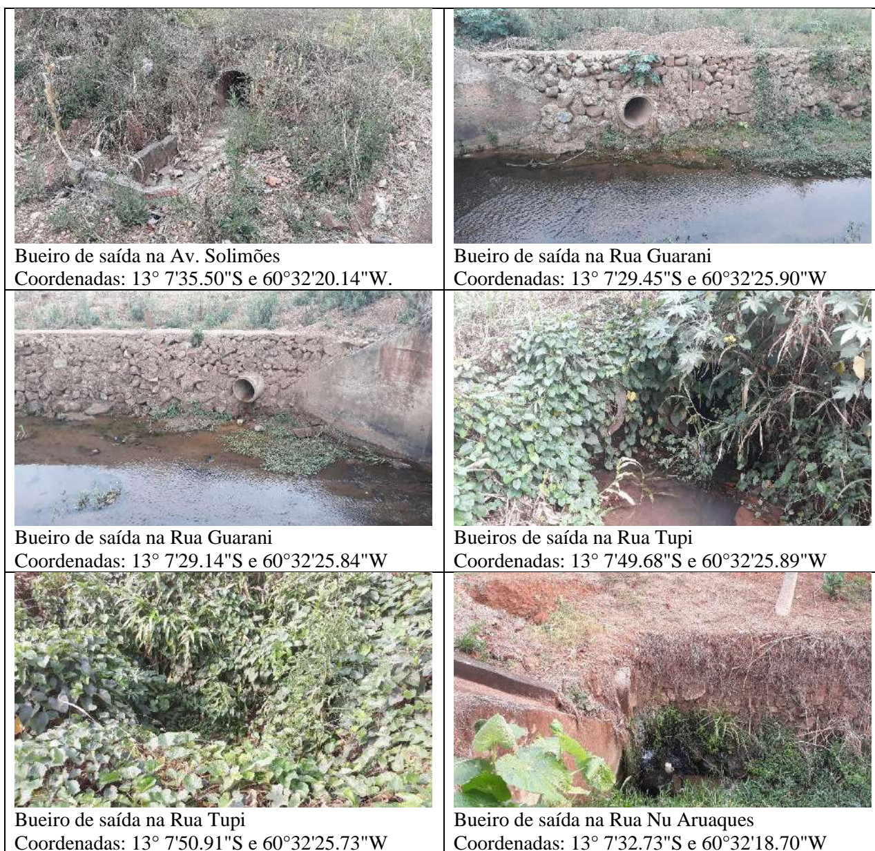
Figura 154 – Bueiro de saída das águas pluviais urbanas em Colorado do Oeste.
