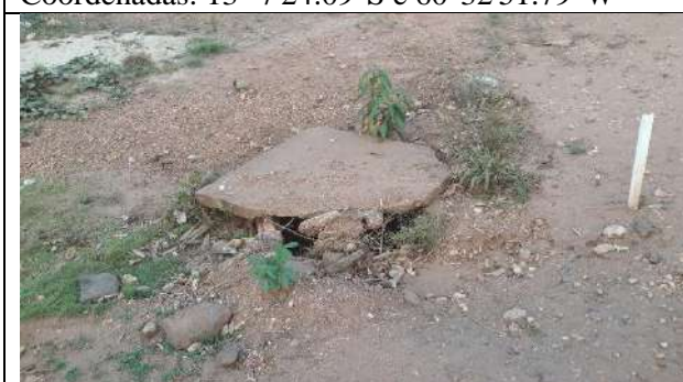
Obstruída e danificada – Av. Xingu Coordenadas: 13° 6'49.57"S e 60°33'16.69"W
