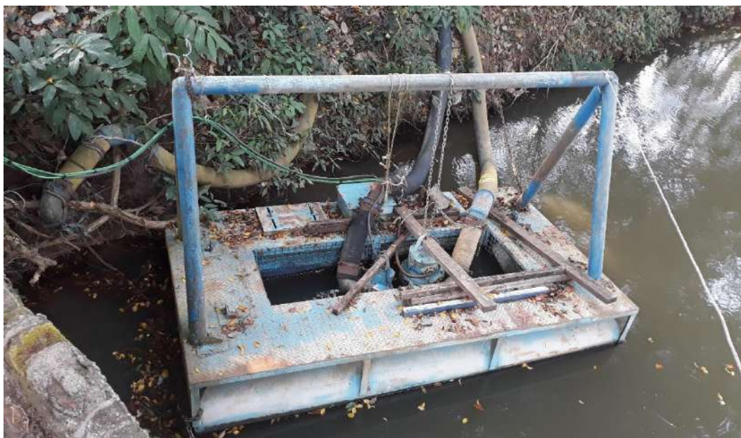
Figura 34 – Sistema de captação do SAA da Sede Municipal.
