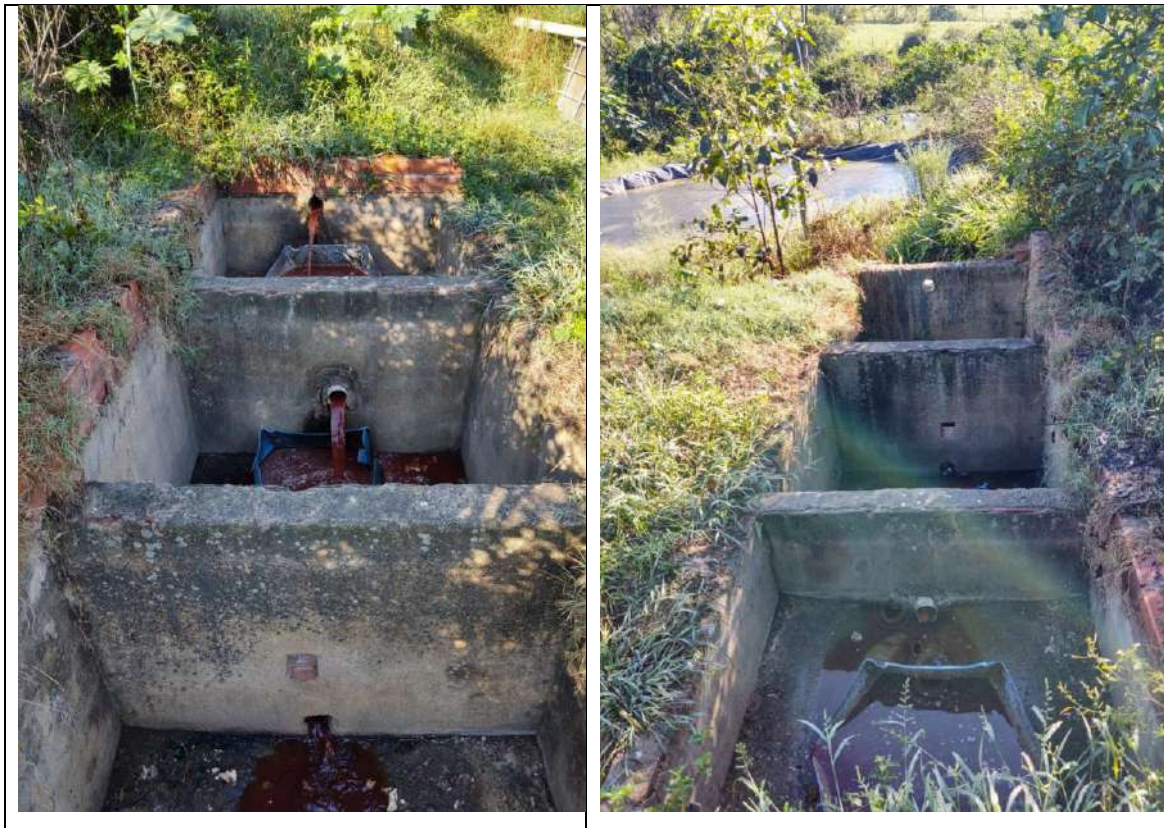
Figura 191 - Tratamento e destinação final dos efluentes
