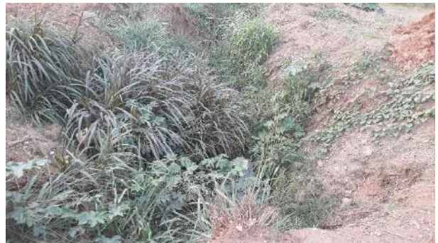
Bueiro de saída na Av. Xingu Coordenadas: 13° 6'49.51"S e 60°33'13.84"W
