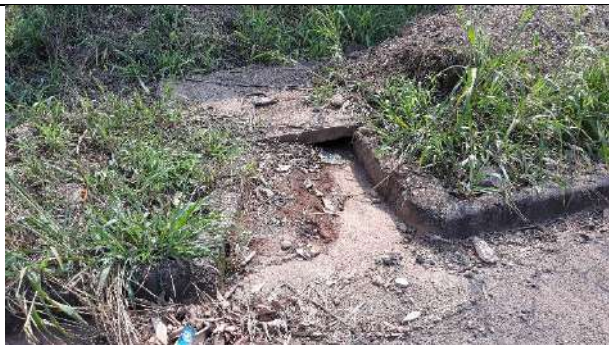
Obstruída – Rua Gês Coordenadas: 13° 7'34.35"S e 60°32'15.07"W
