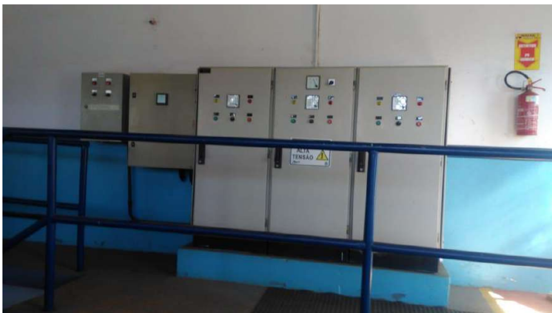
Figura 55 - Painel de comando e sistema de automação da Estação Elevatória de Água Tratada 2 e 3 do SAA.
