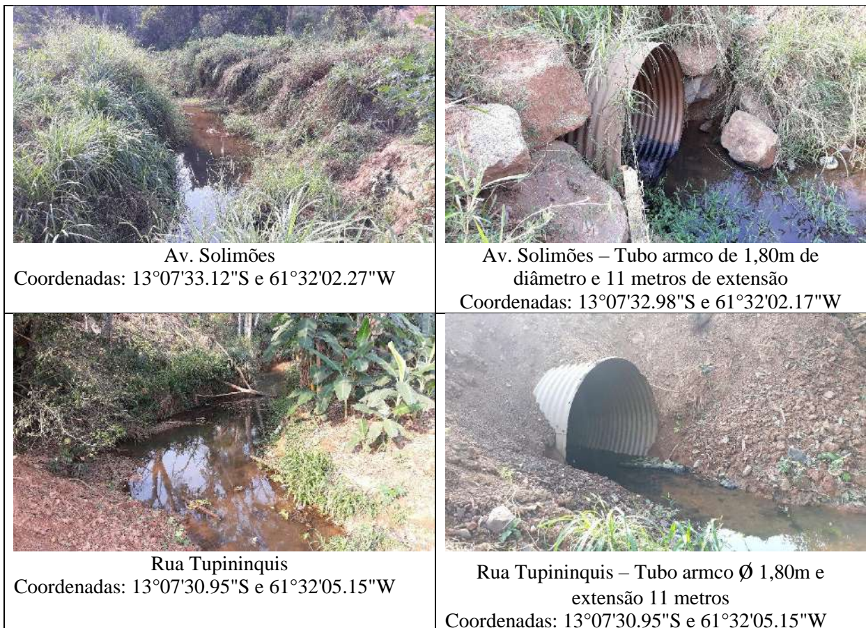
Figura 143- Canal 1 de Macrodrenagem na Sede de Colorado do Oeste
