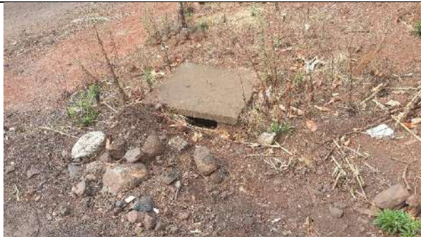
Boca simples obstruída na Rua Humaitá Coordenadas: 13° 7'59.44"S e 60°32'27.77"W
