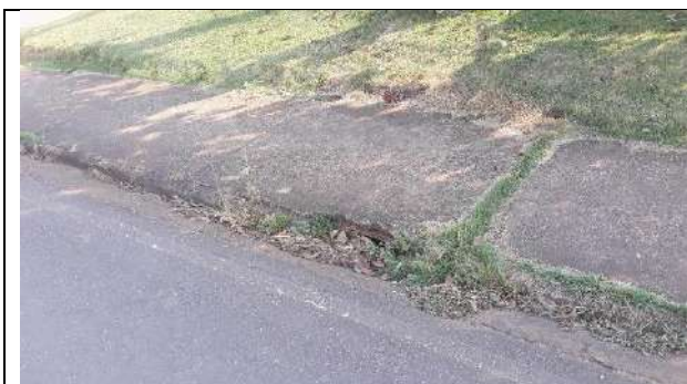
Obstruída – Rua Acácia Coordenadas: 13° 7'24.09"S e 60°32'51.79"W
