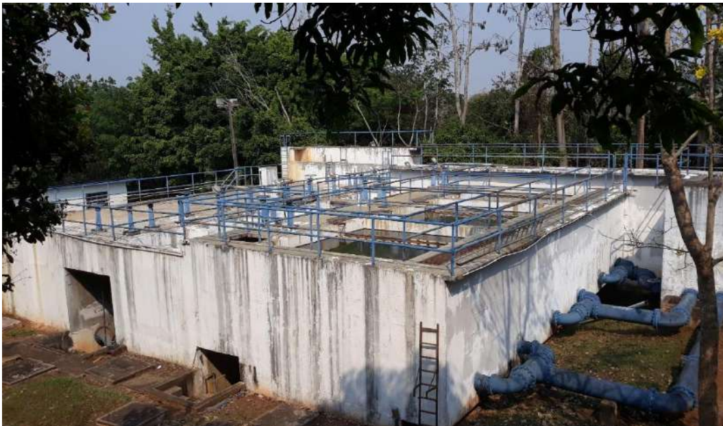
Figura 42 - Estação de tratamento de água
