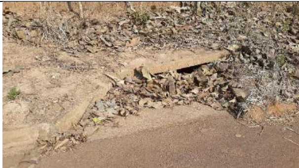
Boca de guia dupla obstruída na Rua Cabixi Coordenadas: 13° 6'57.08"S e 60°33'2.45"W
