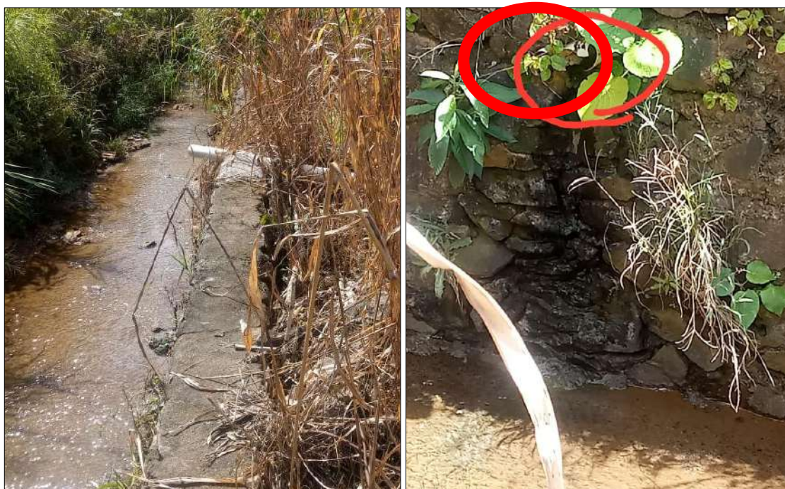
Figura 18 — Esgoto clandestino no Centro Municipal de Colorado do Oeste.
