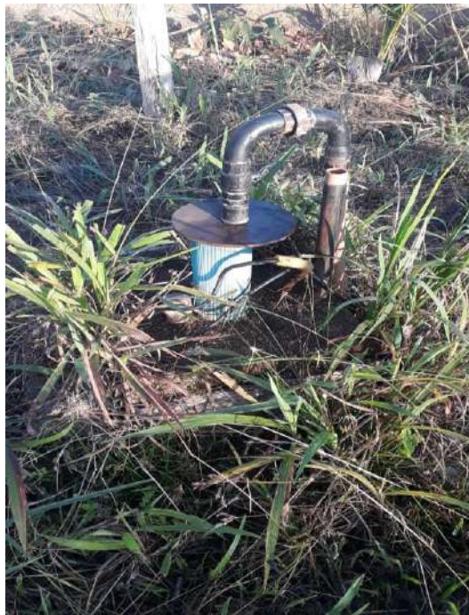
Figura 63 - Poço tubular profundo localizado na Zona Rural
