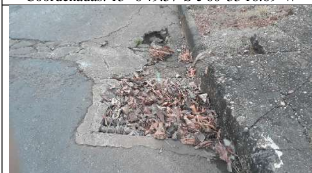
Obstruída – Rua Bartolomeu Bueno Coordenadas: 13° 7'0.38"S e 60°33'14.96"W
