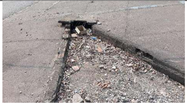
Obstruída – Av. Juruá esquina com Rua Nu Aruaques Coordenadas: 13° 7'49.68"S e 60°32'15.66"W
