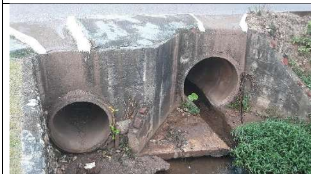
Rua Humaitá – bueiro, 1 manilha de 1m e outra de 1,2m Coordenadas: 13°07'45.89"S e 61°32'30.00"W
