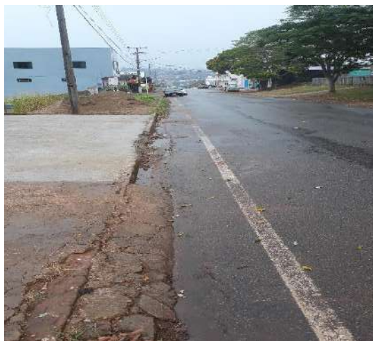
Sarjeta danificada – Rua Humaitá Coordenadas: 13° 7'16.51"S e 60°32'33.90"W
