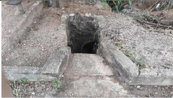
Falta de tampa – Rua Tupi Coordenadas: 13° 7'24.18"S e 60°32'29.83"W
