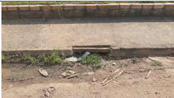
Obstruída – Rua Magnopolis Coordenadas: 13° 7'44.23"S e 60°32'42.38"W
