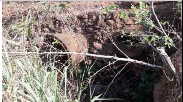
Rua Cabixi – Lançamentos galerias da microdrenagem em ambos os lados Coordenadas: 13°07'08.48"S e 60°33'00.84"W
