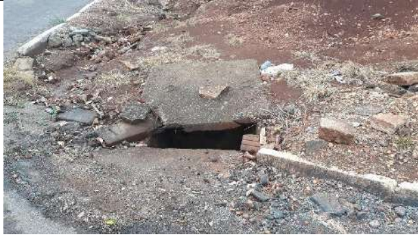
Sarjeta e boca de lobo danificadas - Rua Tupi esquina com Av. Solimões Coordenadas: 13° 7'36.73"S e 60°32'27.77"W
