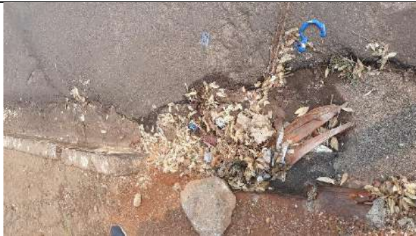
Boca de sarjeta obstruída na Av. Rio Negro Coordenadas: 13° 7'23.17"S e 60°32'39.99"W
