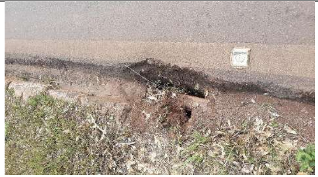
Boca de sarjeta com grelha obstruída e danificada na Av.Mal Rondon Coordenadas: 13° 7'22.72"S e 60°32'40.77"W
