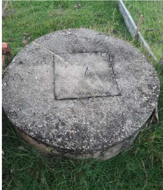
Figura 62 - Poço amazonas em residência na Zona Rural
