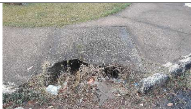
Mal posicionada danificada e obstruída – Av. Solimões Coordenadas: 13° 7'36.66"S e 60°32'31.11"W
