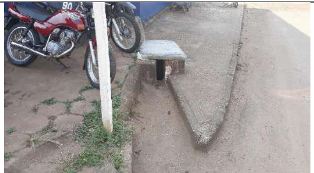
Mal Projetada e dimensionada – Av. Juruá Coordenadas: 13° 7'53.10"S e 60°32'41.98"W
