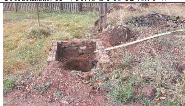
Obstruída e sem tampa - Rua Tupi Coordenadas: 13° 7'54.28"S e 60°32'25.33"W
