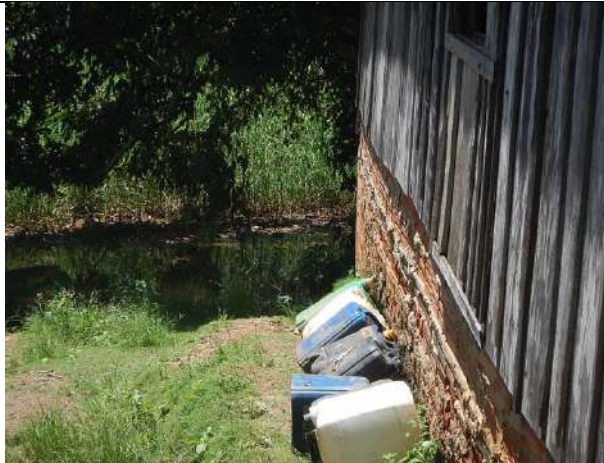
Alteamento de alicerce em moradia localizada na planície de inundação Fonte: CPRM (2016)
