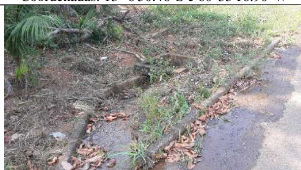
Obstruída e danificada – Rua Rio Grande do Sul Coordenadas: 13° 6'53.03"S e 60°32'36.77"W
