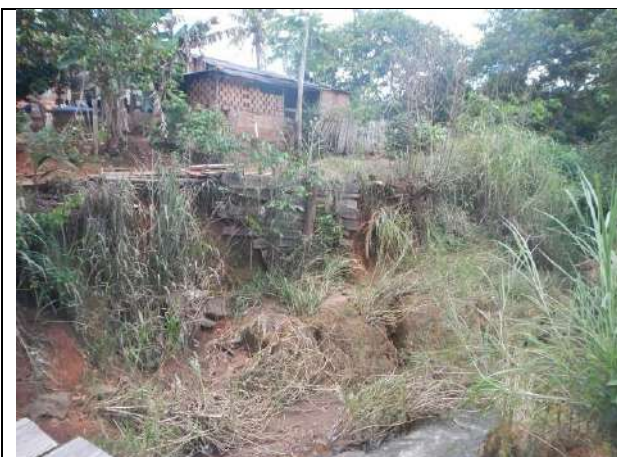
Rua Acácia, entre Avenidas Solimões e Amazonas Fonte: CPRM (2016)
