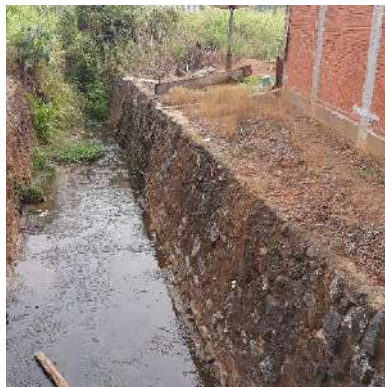
Figura 135 – Lançamento de esgoto doméstico identificado no ponto 4.
