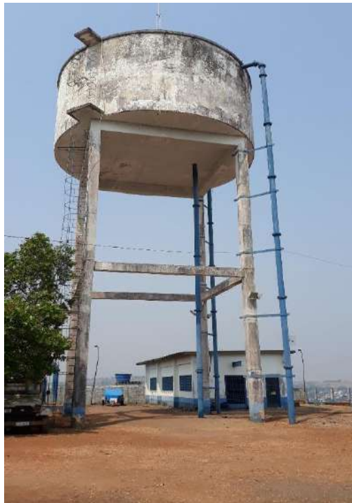
Figura 58 - Reservatório elevado 250 m 3 .
