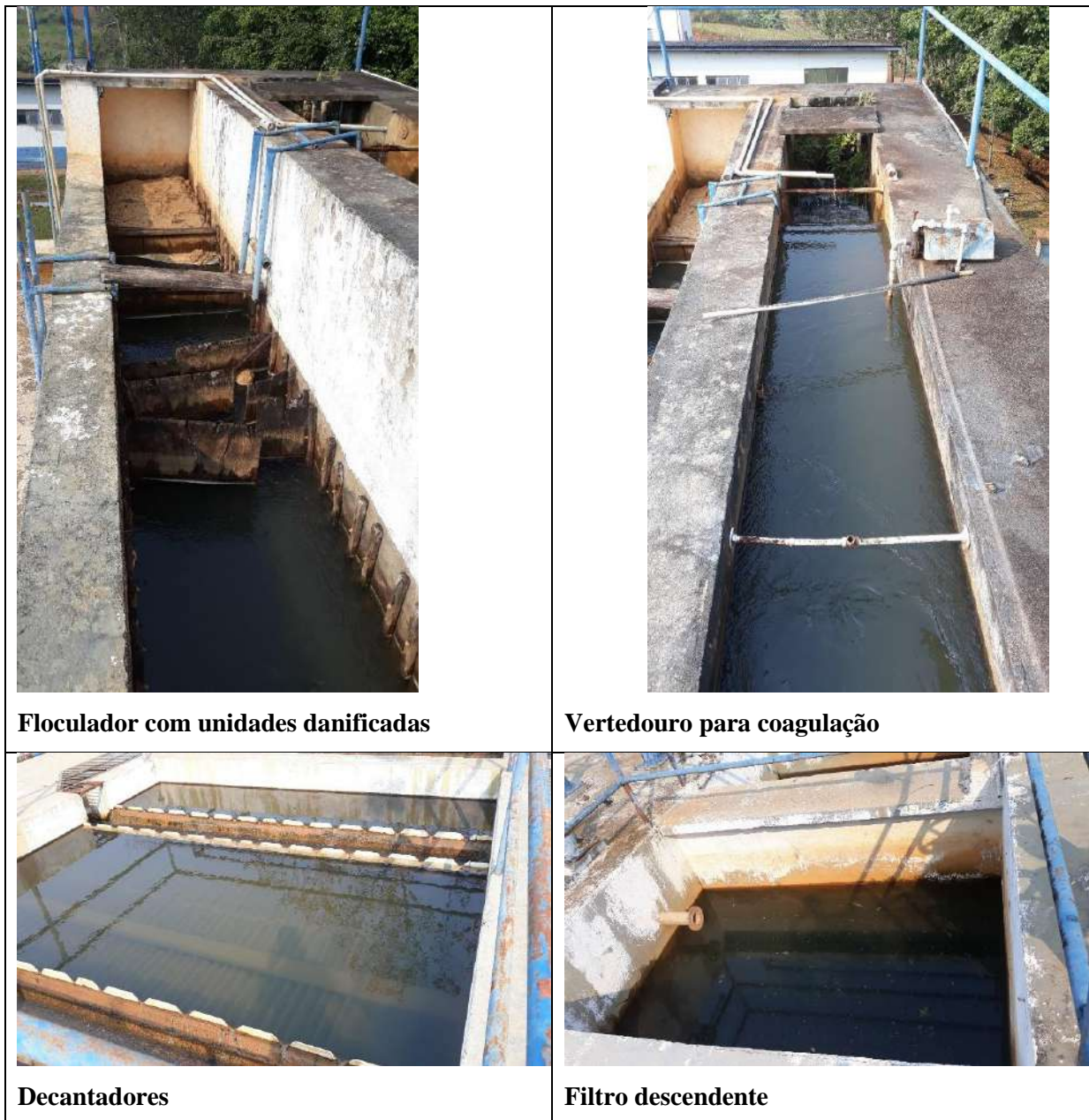
Figura 43 - Defeitos no Sistema de Tratamento de água
