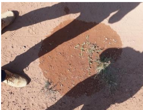
Figura 90 - Vazamento na rede identificado em dia de visita in loco no distrito Planalto São Luiz.
