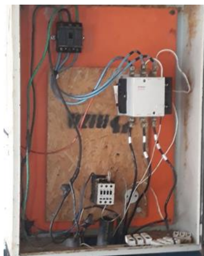
Figura 84 - Painel de comando de acionamento da EEAB Planalto São Luiz.
