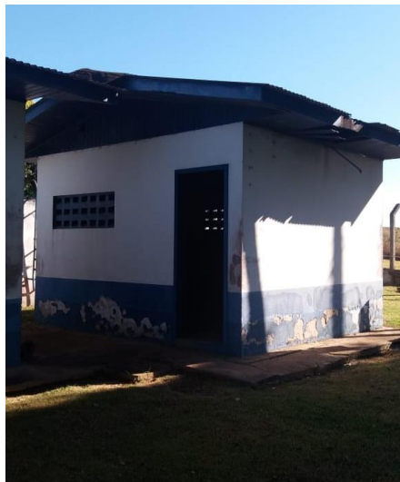
Figura 42 - Vista do abrigo do painel de comando.
