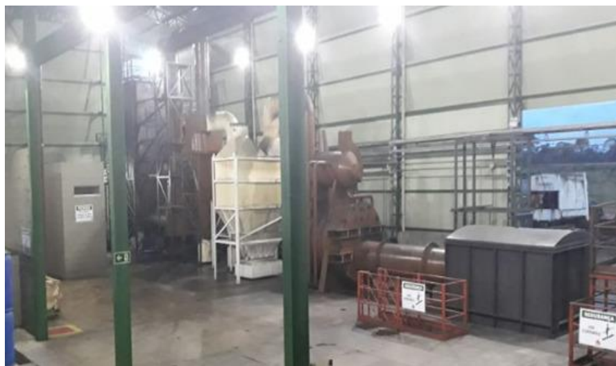
Figura 246 – Incinerador utilizado queima dos RSS
