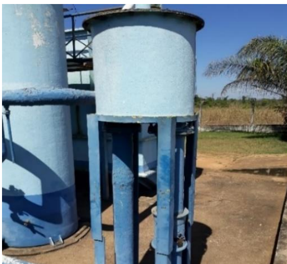
Figura 48 - Tanque de cloração.
