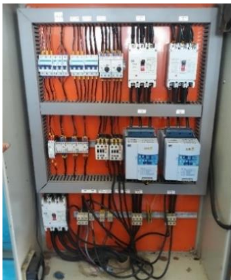
Figura 61 - Painel de comando EEAT1.
