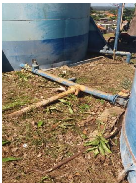
Figura 69 – Detalhe de ligação entre os reservatórios 02 e 03.
