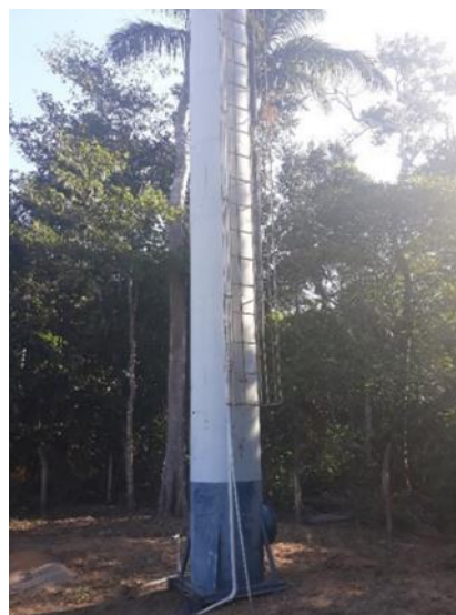
Figura 105 - Reservatório Vila São João.
