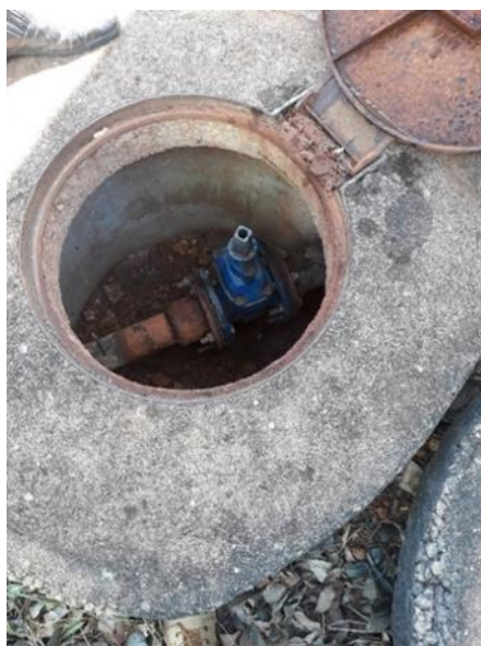
Figura 70 - Registro Gaveta DN 100 mm do tubo de distribuição dos reservatórios 02 e 03
