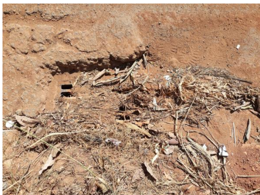
Figura 190 - Boca de lobo da RO-497, obstruída, necessitando de limpeza.
