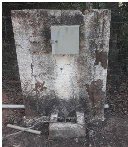
Figura 102 - Chave de acionamento do poço Vila São João.
