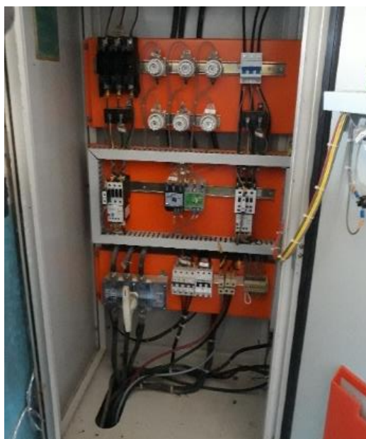
Figura 62 - Painel de comando EEAT2.
