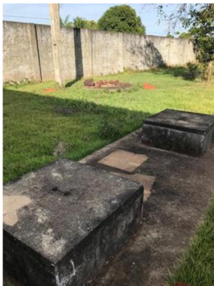
Figura 139 - Tanque Séptico e Sumidouro do Centro Estadual de Educação de Jovens e Adultos - CEEJA de Cabixi.
