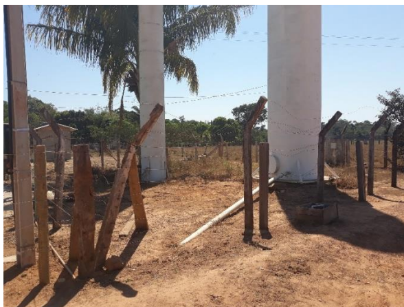
Figura 95 - Local do poço e reservatório de abastecimento de água da Vila Neide.
