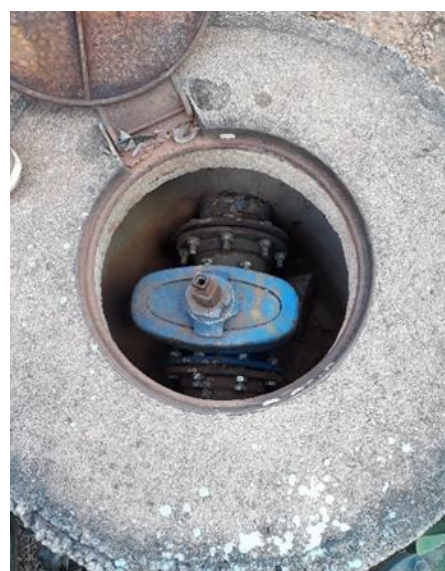
Figura 66 – Registro Gaveta DN 150 mm do tubo de saída de água para rede de distribuição.
