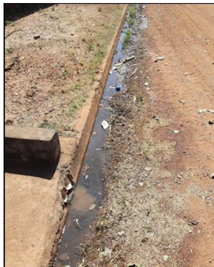
Figura 140 - Lançamento de águas cinzas na avenida Cabixi.
