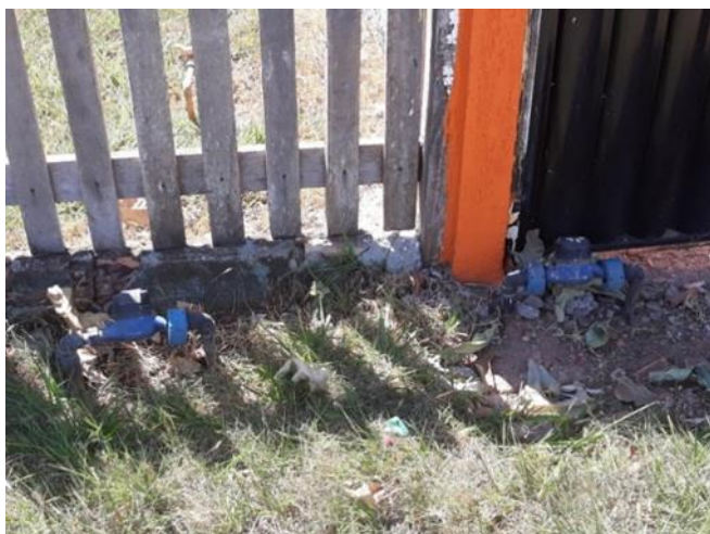
Figura 74 - Hidrômetros do SAA Cabixi.
