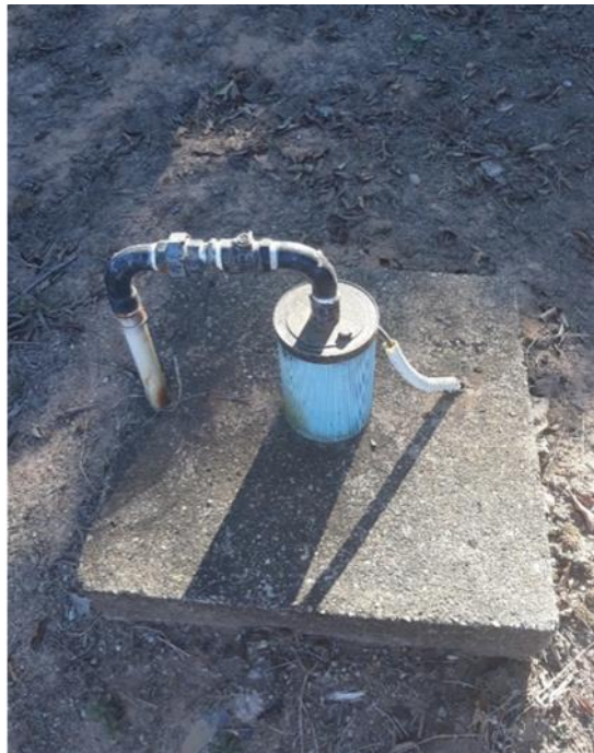
Figura 101 - Poço tubular Vila São João.
