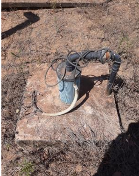
Figura 97 - Poço tubular Vila Neide.
