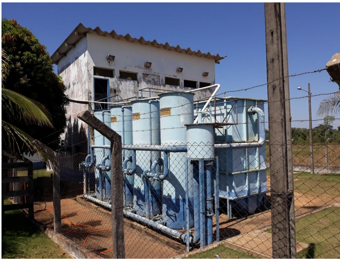
Figura 29 - Estação de Tratamento de Água em Cabixi.
