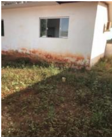
Figura 154 – Fossa rudimentar do Centro de Saúde São Francisco, na Sede Municipal.
