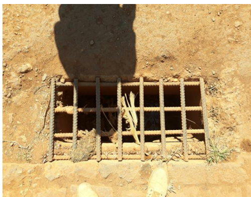
Figura 192 - Boca de lobo da RO-497, necessitando de limpeza.
