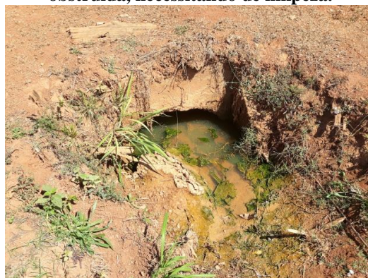
Figura 193 - Tubo de lançamento da microdrenagem da RO-497, parcialmente obstruída, necessitando de limpeza.
