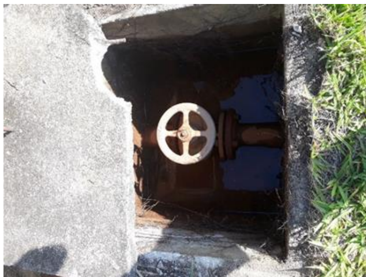
Figura 85 - Registros gaveta do sistema de adução de água bruta do Planalto São Luiz.
