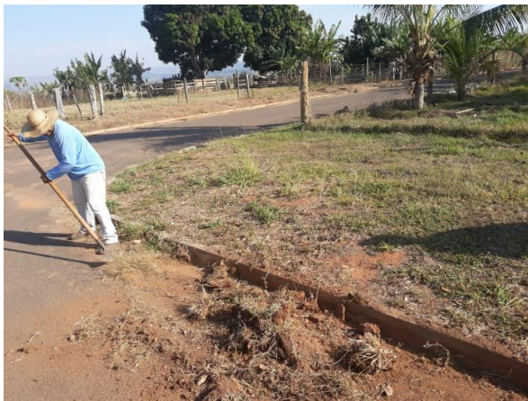
Figura 232 – Limpeza de sarjeta no Distrito Planalto São Luiz.
