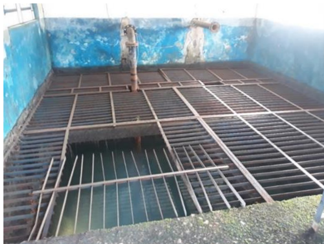
Figura 78 - Reservatório de acumulação da nascente da SAC do Planalto São Luiz.
