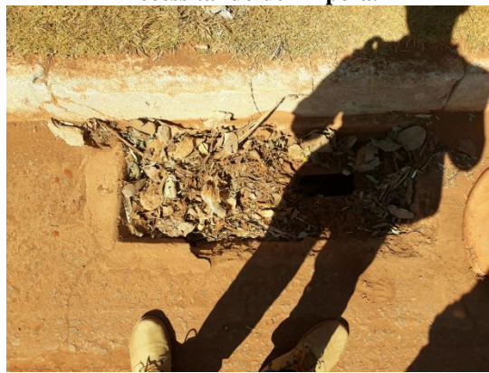
Figura 189 - Boca de lobo da RO-497, obstruída, necessitando de limpeza.
