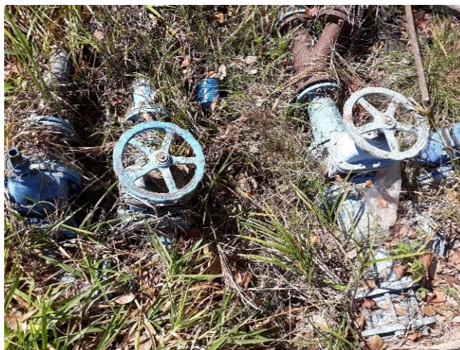
Figura 39 - Registros gaveta do sistema de adução de água bruta.
