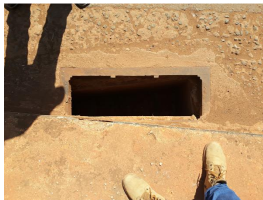
Figura 191 - Boca de lobo da RO-497, sem grelha.
