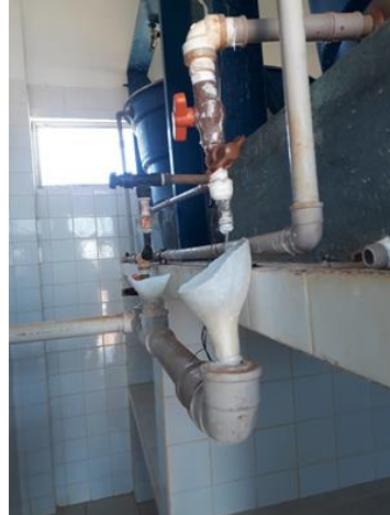
Figura 53 - Dosador de cloro
