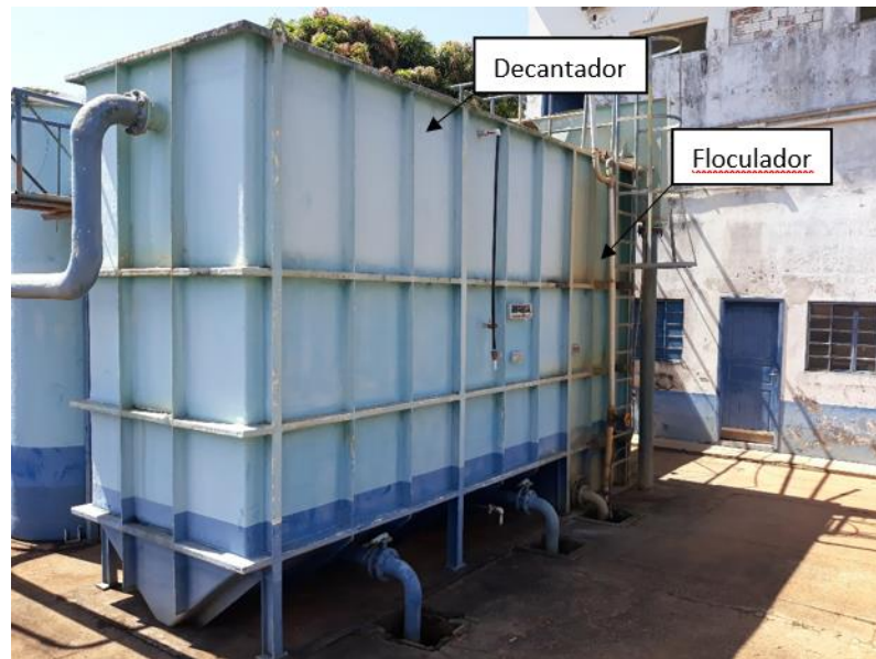
Figura 46 - Decantador e floculador da ETA Cabixi.
