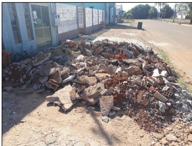
Figura 239 - Resíduos de Construção Civil disposto no passeio.
