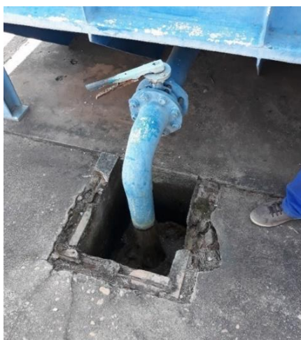
Figura 49 - Registro de descarga DN 100 mm.
