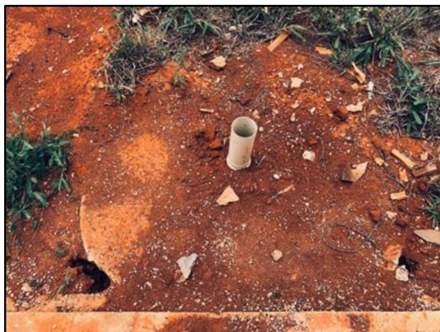
Figura 137 - Fossa rudimentar instalada nas proximidades do CRAS em Cabixi.
