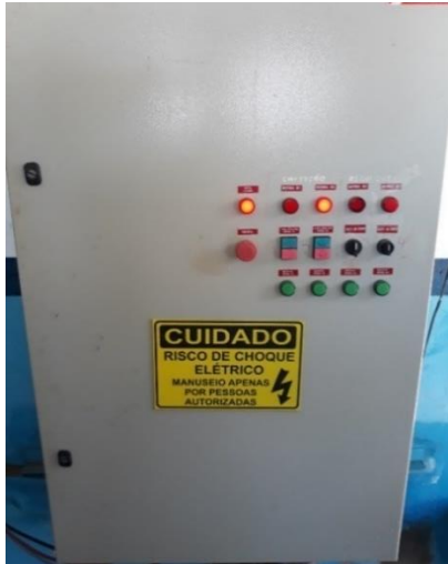
Figura 40 - Vista externa do painel de comando.
