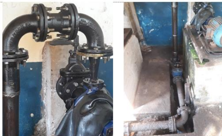
Figura 82 - Barrilete de recalque do EEAB Distrito Novo Plano.
