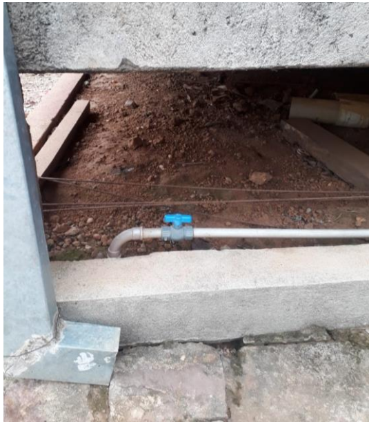
Figura 112- Ligações domiciliares de água da Vila São João
