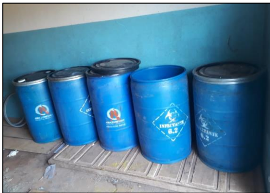
Figura 243 - Vista interna do abrigo de armazenamento temporário de RSS.
