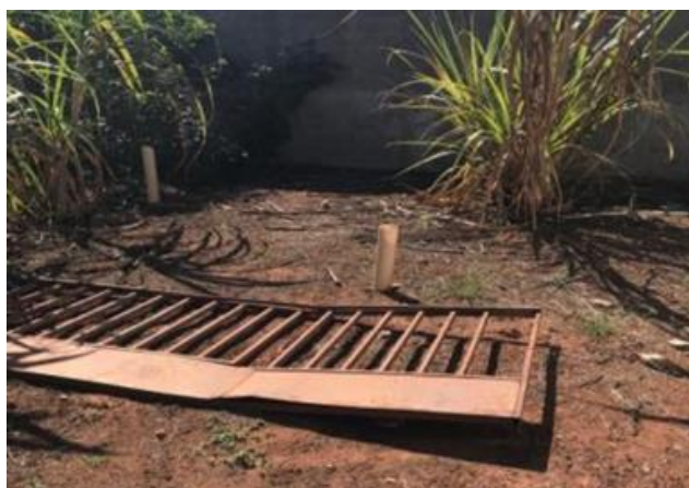
Figura 142 - Fossa rudimentar instalada no Distrito Planalto São Luiz.
