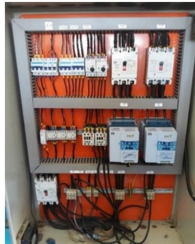
Figura 41 - Vista interna do painel de comando.
