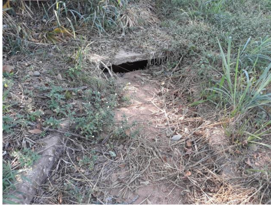
Figura 194 - Boca de lobo da Avenida Tupi, necessitando de limpeza.
