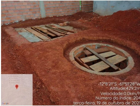
Construção de fossa séptica no quintal– Av. Tancredo Neves 12°08'21.00\"S e 61°51'28.00\"W
