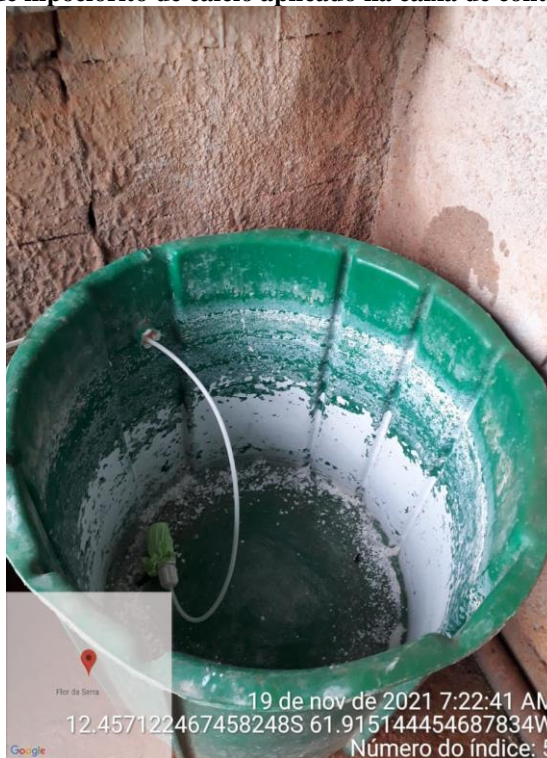
Figura 102 – Adição de hipoclorito de cálcio aplicado na caixa de controle na saída dos filtros
