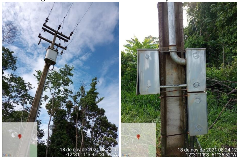
Figura 121 – Transformador e subestação trifásica
