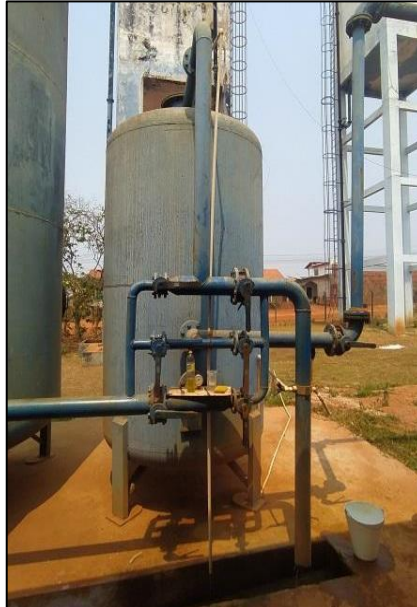
Figura 70 - Filtro da ETA da Sede Municipal.
