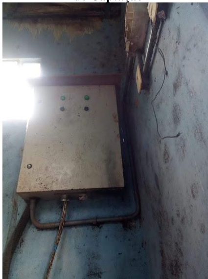
Figura 92 - Vista Interna do Painel de Captação
