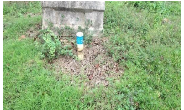
Fossa Séptica na EMEF Euzébio de Queiroz – Área Rural
