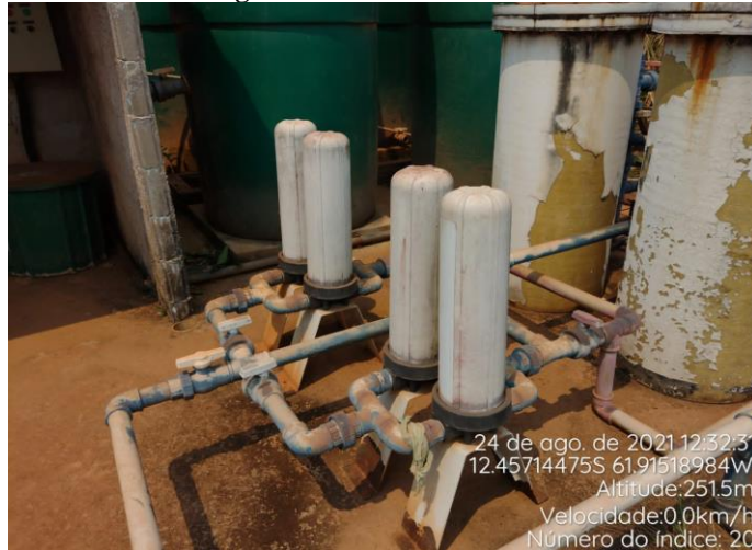
Figura 101 - Filtros da ETA
