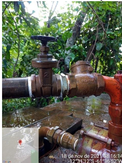
Figura 122 - Registro do sistema de adução de água bruta
