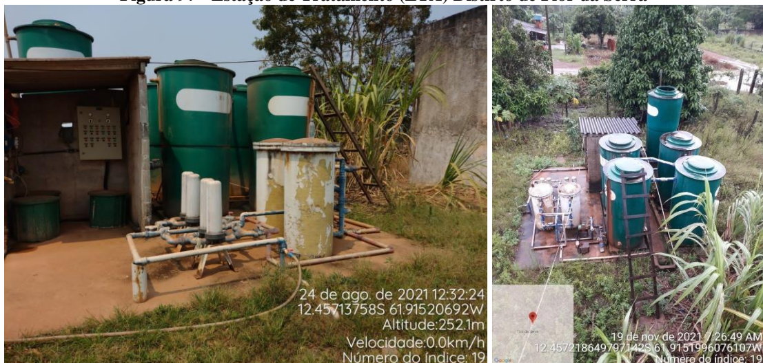
Figura 97 - Estação de Tratamento (ETA) Distrito de Flor da Serra
