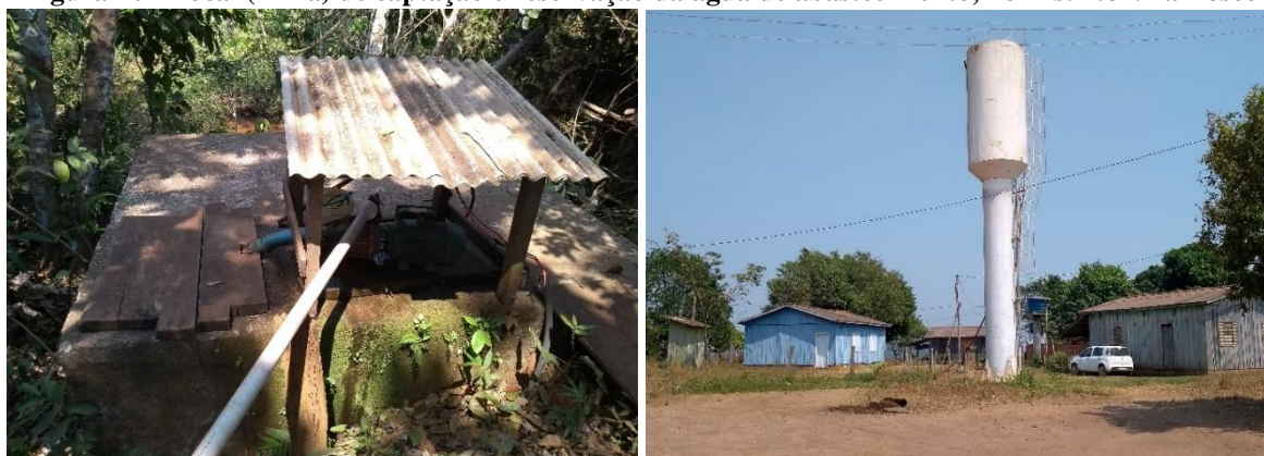
Figura 46 - Local (Mina) de captação e reservação da água de abastecimento, no Distrito Vila Bosco
