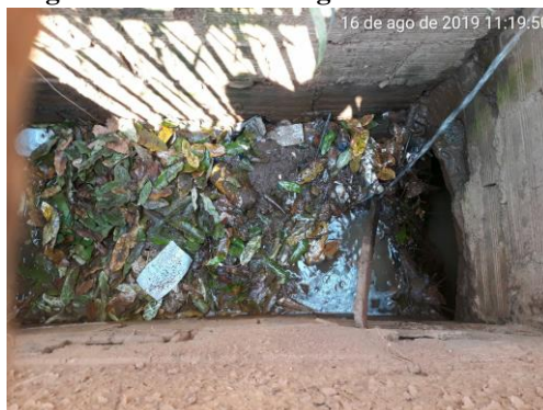
Ligação clandestina de esgoto em boca de lobo Coordenadas geográficas 12°07'57.25"S e 61°51'31.58"W
