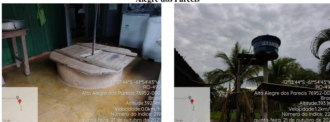
RO-490— Poço amazonas Coordenadas geográficas 12°13'44"S e 61°54'43"W
