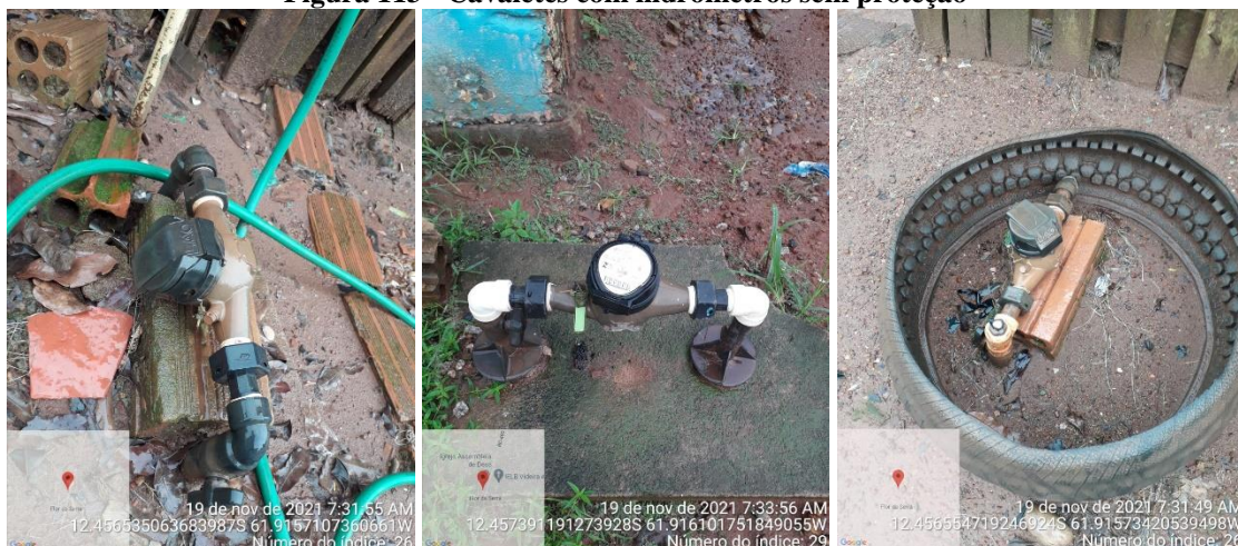
Figura 113 - Cavaletes com hidrômetros sem proteção
