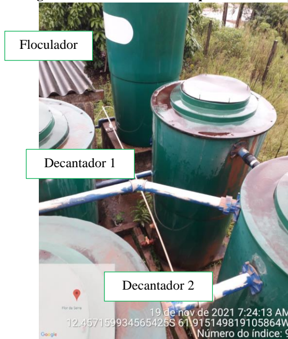
Figura 100 – Floculador e tanques de decantação
