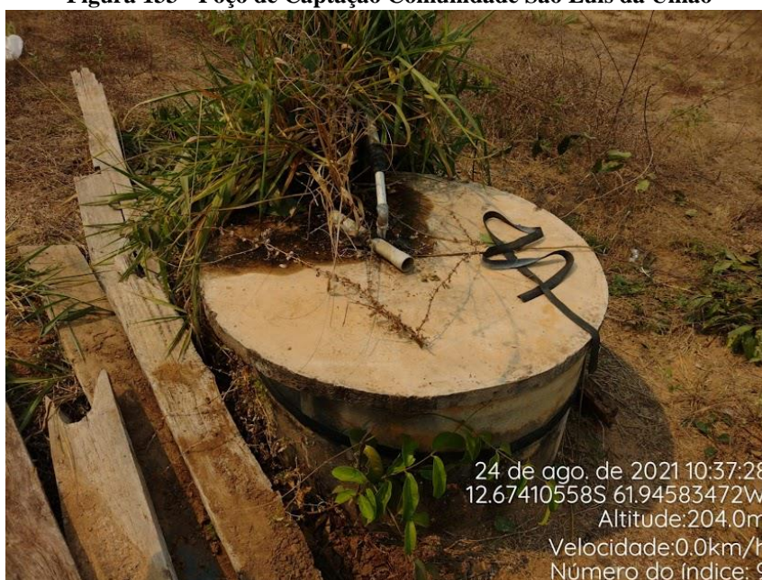
Figura 133 - Poço de Captação Comunidade São Luís da União
