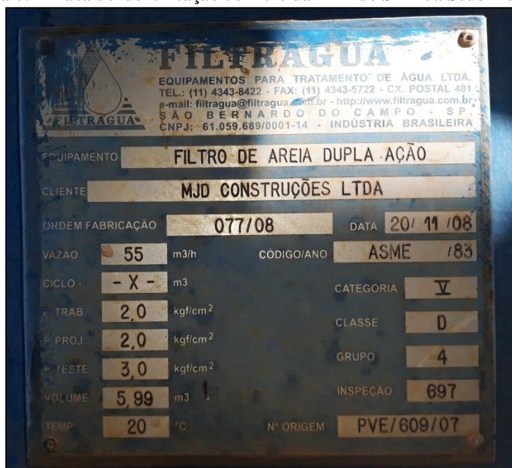
Figura 65 - Placa de identificação do filtro da ETA do SAA da Sede Municipal
