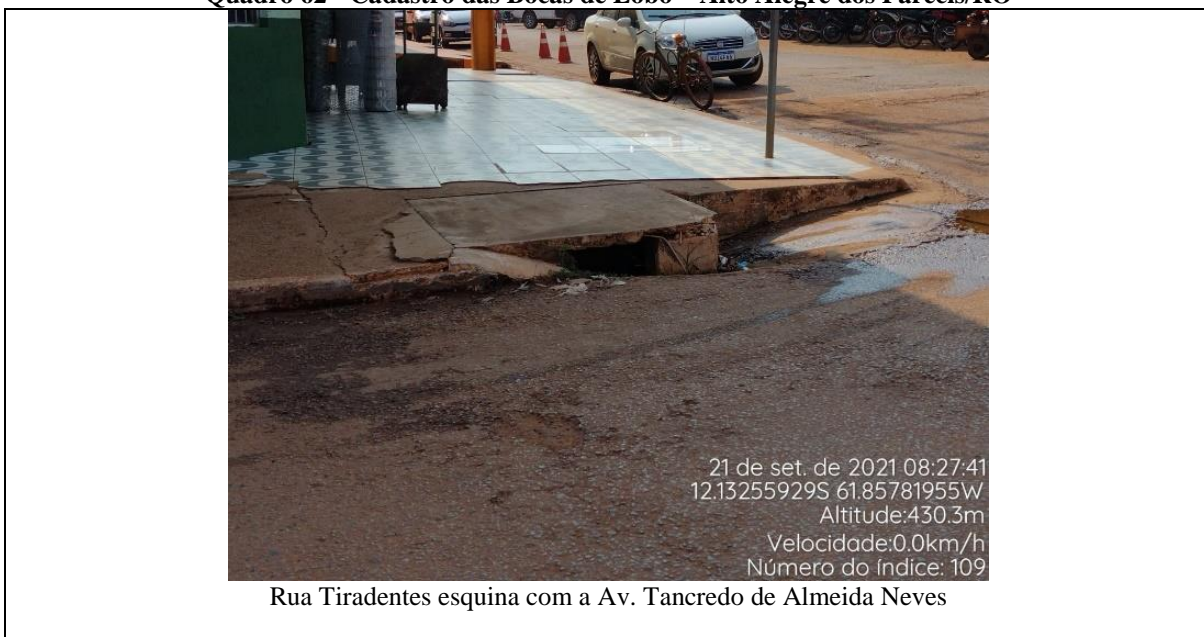
Quadro 62 - Cadastro das Bocas de Lobo – Alto Alegre dos Parecis/RO
