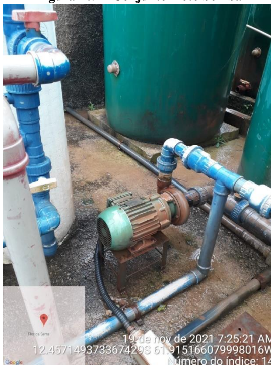
Figura 109 – Conjunto moto bomba
