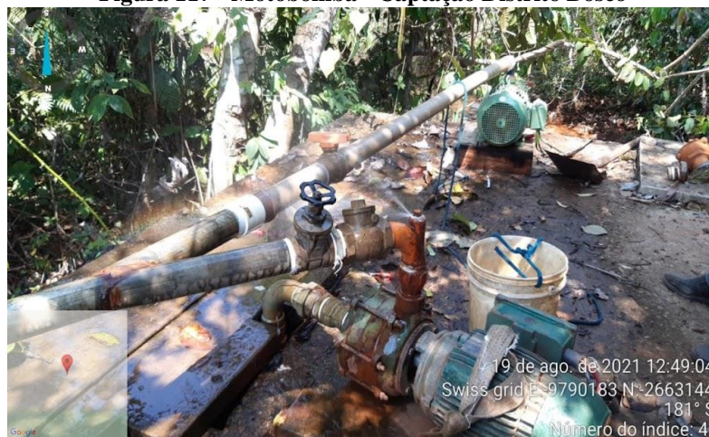
Figura 117 - Motobomba - Captação Distrito Bosco
