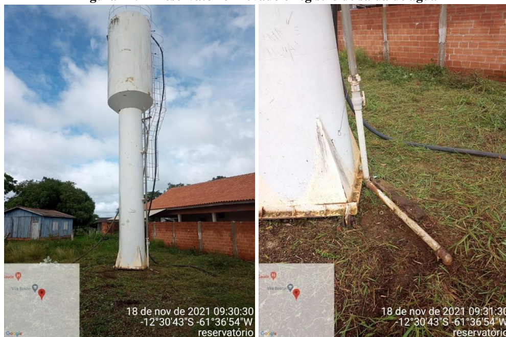
Figura 125 – Reservatório Elevado e registro de saída de água
