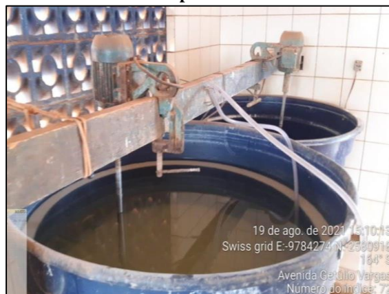
Bomba misturadora e tanques de mistura de sulfato de alumínio.
