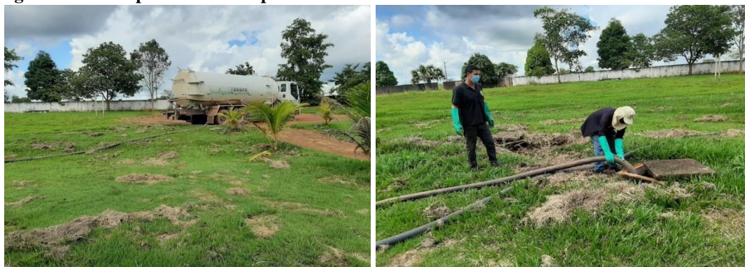
Figura 163 – Limpeza da fossa séptica da EMEF Marcelo Gama - Área rural - Linha 176 km 05
