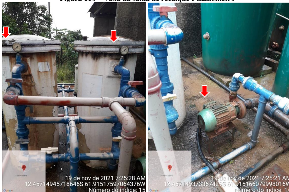
Figura 110—Vista da saída de recalque e manômetro
