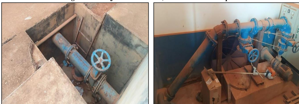
Figura 77 - Conjunto motobomba, ETA da Sede Municipal
