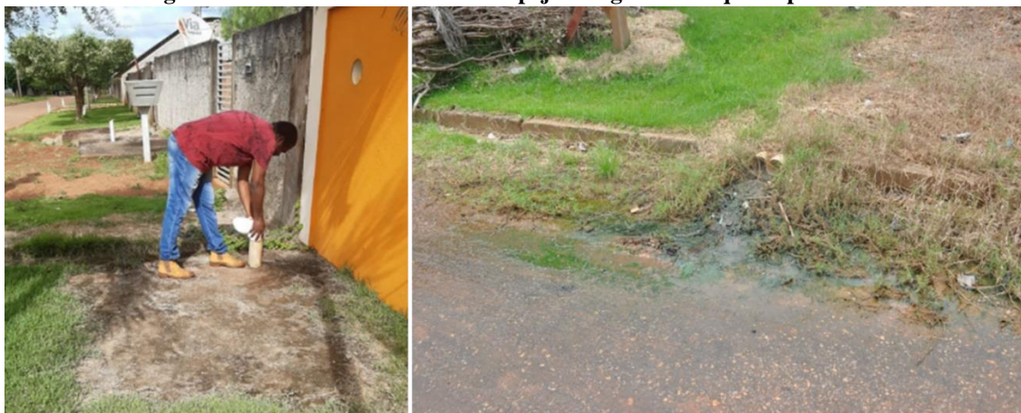
Figura 31 - Fossas mal vedadas e despejo de água de tanques e pia na rua
