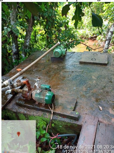
Figura 116 – Sistema de captação da água bruta
