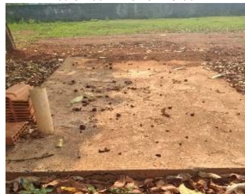
Fossa Séptica na EMEF Severino Batista Costa - Sede 12° 7'25.21\"S e 61°51'17.67\"W
