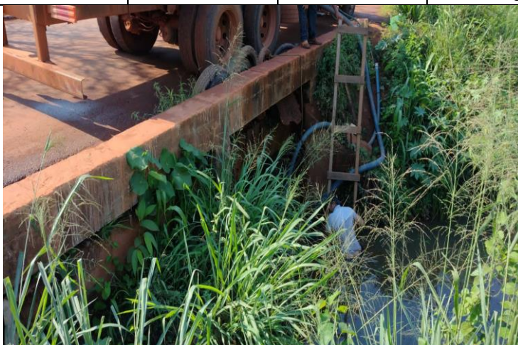
Rua Deodoro da Fonseca
