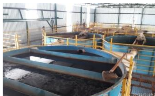
Estação de tratamento de efluentes - ETE
