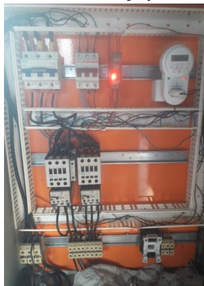
Figura 93 - Vista Externa do Painel de Captação
