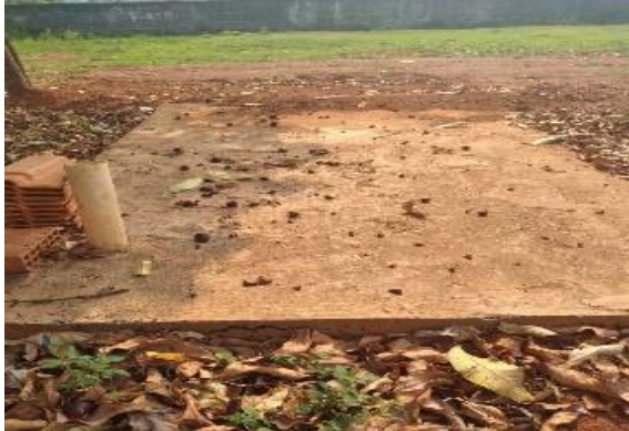
Fossa Séptica na EMEF Severino Batista Costa - Sede
