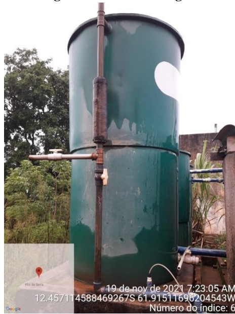
Figura 96 – Chegada da adutora de água bruta na ETA
