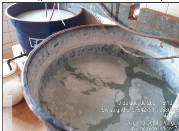
Bomba dosadora e tanques de diluição de polímero não iônico e hipoclorito de cálcio.
