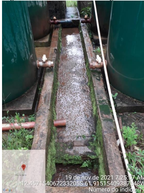
Figura 104 – Canaleta de descarga da ETA
