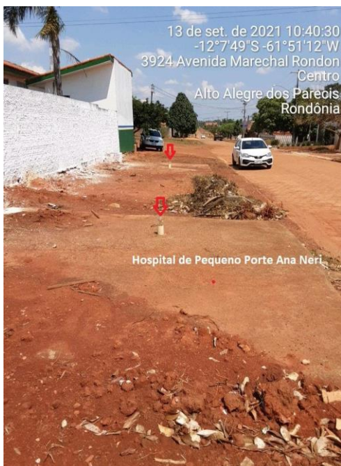
Fossa Rudimentar no Hospital de Pequeno Porte Ana Neri – Sede
