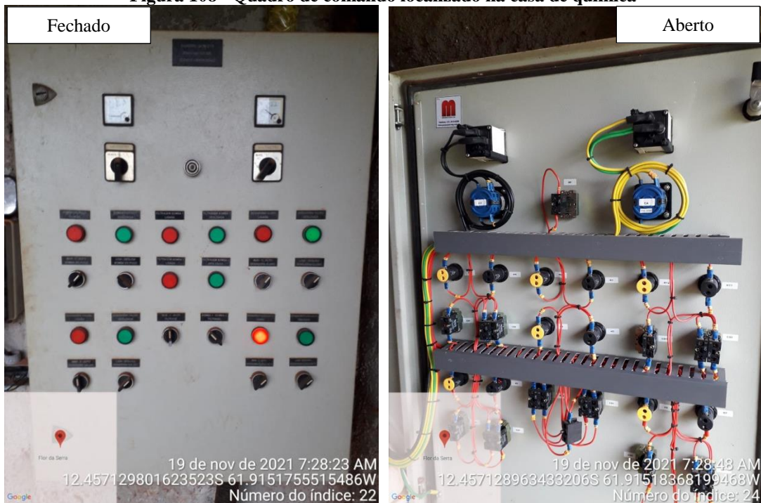
Figura 108 - Quadro de comando localizado na casa de química
