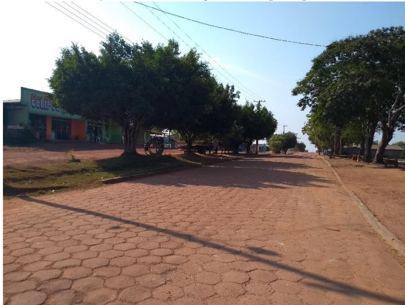
Figura 190 - Meio-fio e sarjeta em boas condições na rua principal do Distrito Flor da Serra
