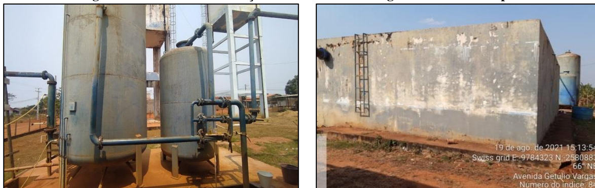
Figura 66 - Unidades da Estação de Tratamento de Água da Sede Municipal.
