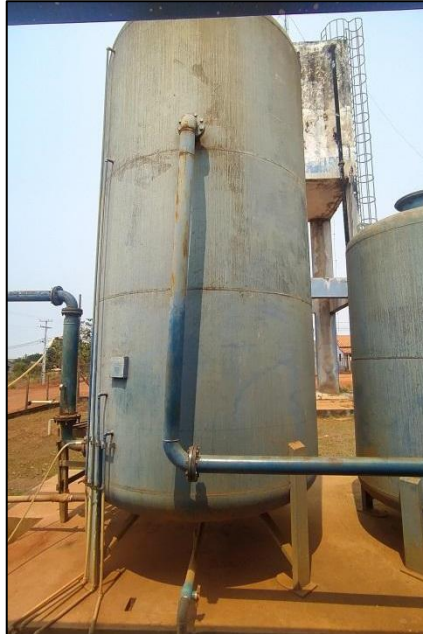
Figura 68 - Floculador Decantador da ETA da Sede Municipal.
