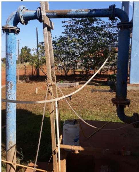
Figura 67 - Dispersor Hidráulico da ETA da Sede Municipal.
