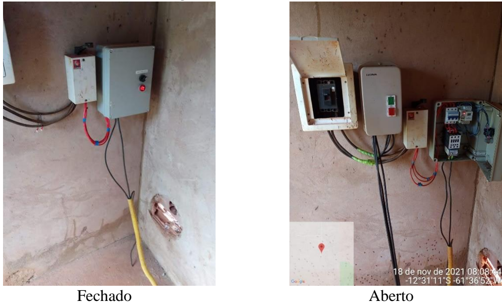
Figura 120 - Vista do Painel
