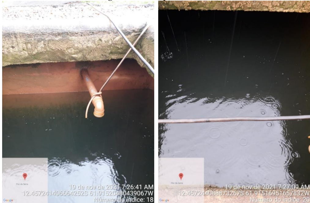
Figura 103 – Tanque de contato
