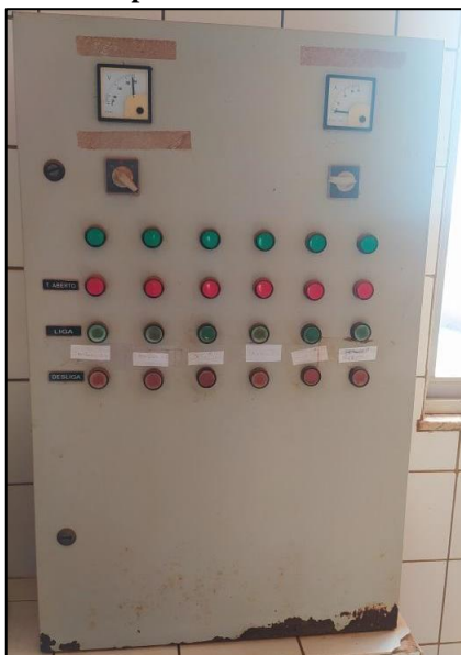
Figura 74 - Vista externa do painel de comando – ETA da Sede Municipal.
