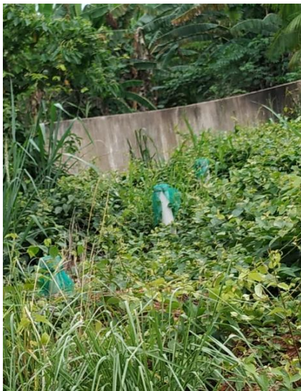
Fossa Rudimentar na EMEF Fernando Sabino - Distrito Flor da Serra
