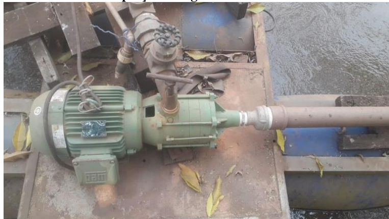
Figura 89 - Motobomba - Captação de Água Bruta Distrito de Flor da Flor da Serra
