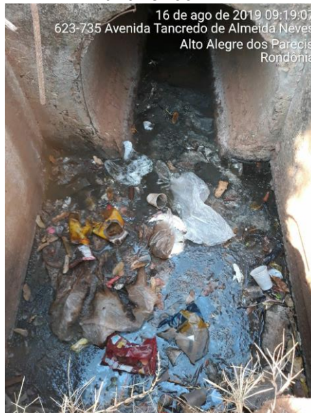
Ligação clandestina de esgoto em boca de lobo Coordenadas 12°07'59.53"S e 61°51'28.44"W
