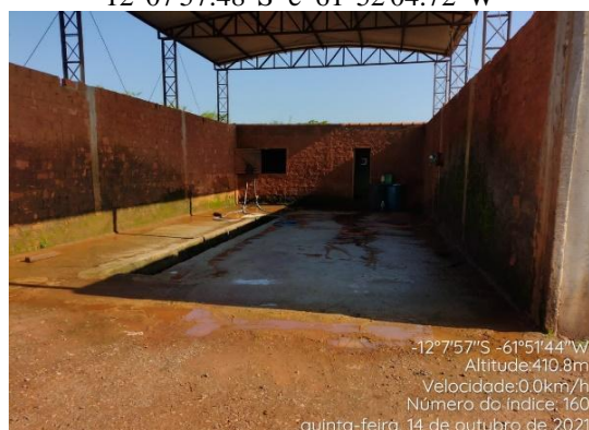
Lavador - Av. Tancredo Neves 12°07'57.00"S e 61°51'44.00"O
