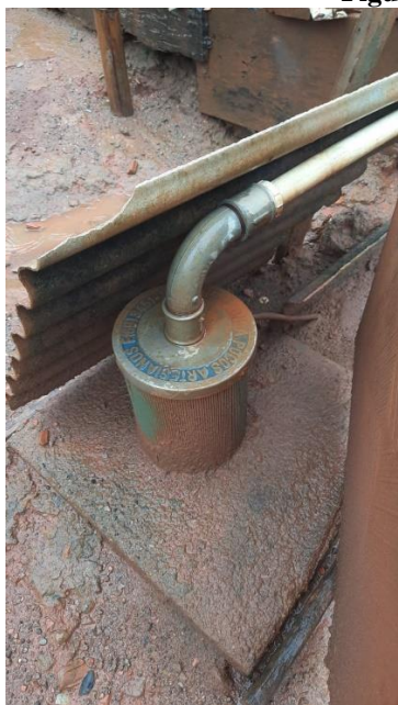
Poço Tubular Profundo Avenida São Francisco, 3940, Jardim das Palmeiras
