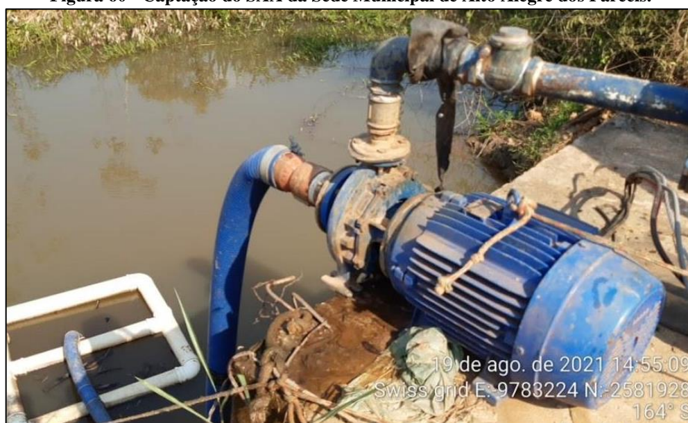
Figura 60 - Captação do SAA da Sede Municipal de Alto Alegre dos Parecis.
