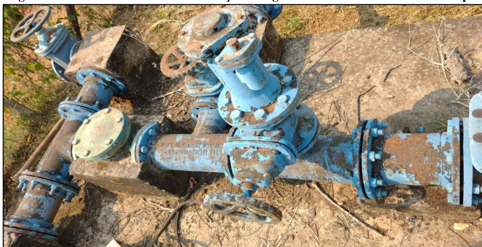
Figura 61 - Barrilete - Sistema de Elevação de Água Bruta do SAA da Sede Municipal.
