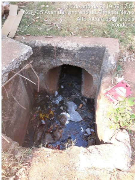
Ligação clandestina de esgoto em boca de lobo Coordenadas 12°07'59.53"S e 61°51'28.44"W
